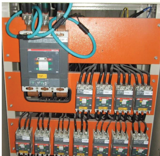
Figura 4.11 Sondas de corriente conectadas en el tablero principal del edificio EARME Etapa 1
