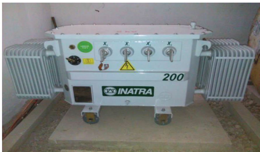
Figura 2.13 Transformador convencional de frente muerto, salida de B.V.
