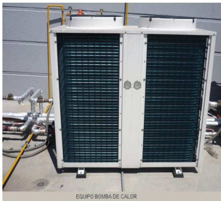
Figura 2.37 Equipo bomba de calor
