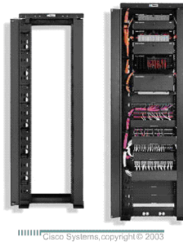
Figura 30 Bastidor de distribución
