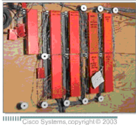
Figura 28 Punto de demarcación
