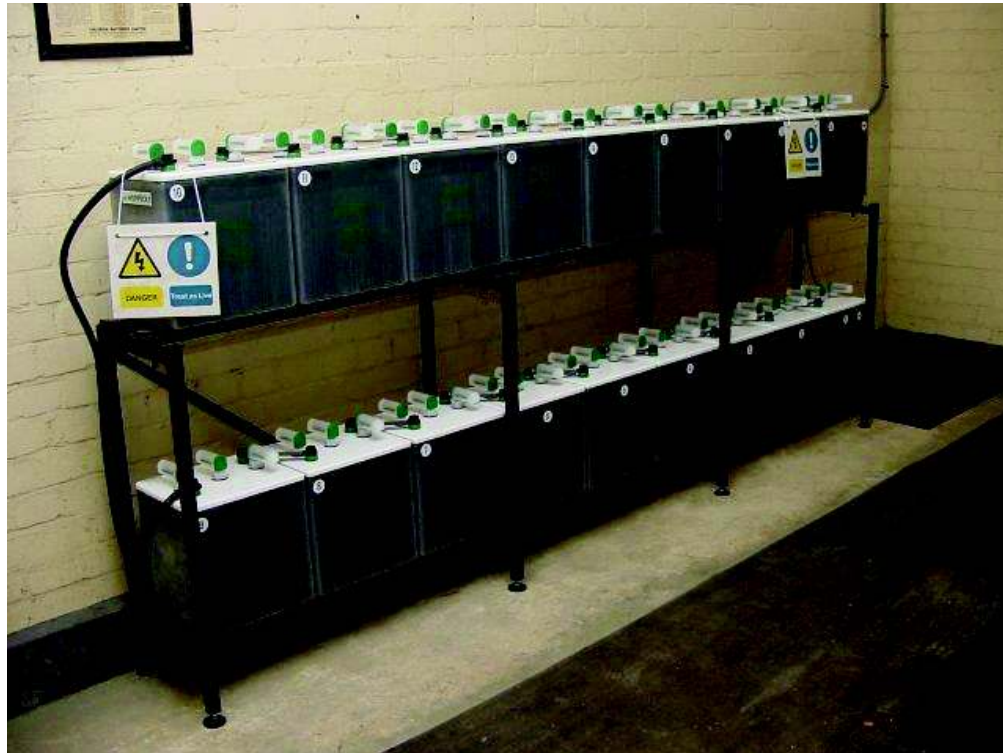
Figura 2.15. Banco de baterías [24]
