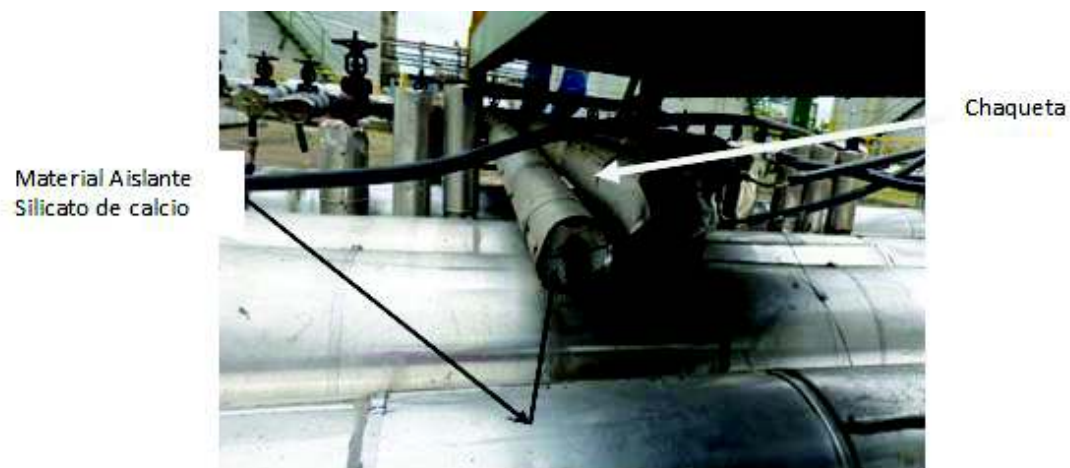
Figura 2.35. Tubería con aislante térmico y chaqueta Fuente:( Propia)
