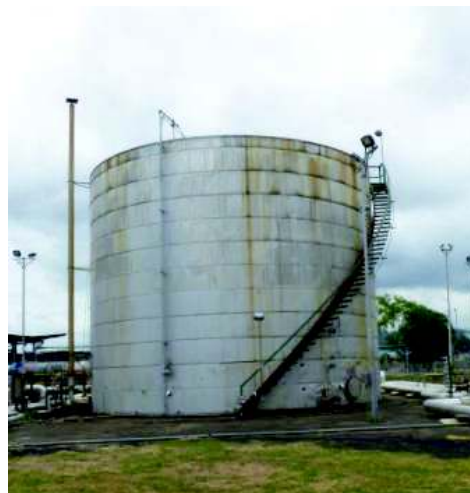
Figura 2.1. Tanque de Almacenamiento de Asfalto en la REE
