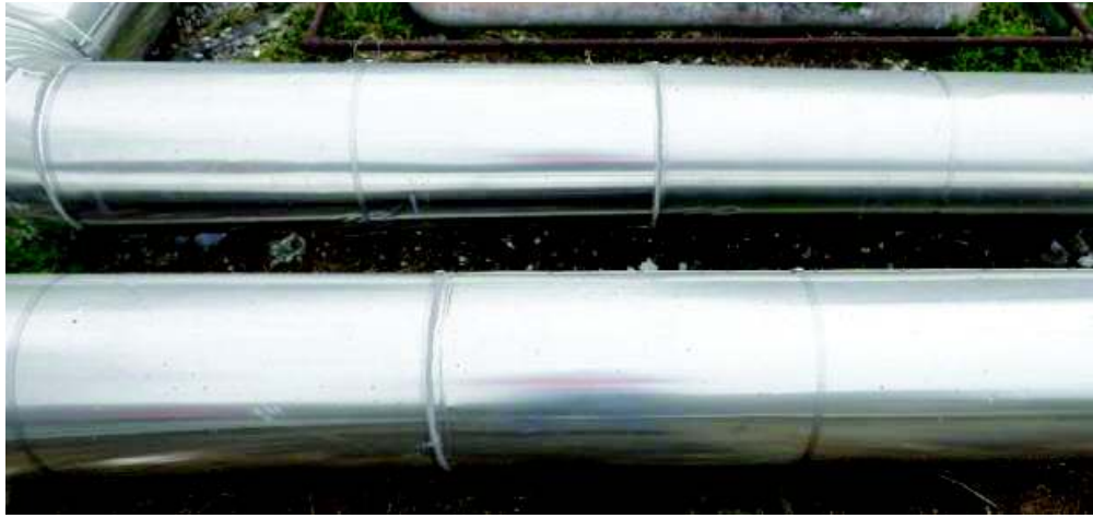
Figura 2.34. Línea de Tubería REE Fuente:(Propia)
