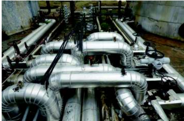
Figura 2.27. Tuberías de la REE Fuente: (Propia)
