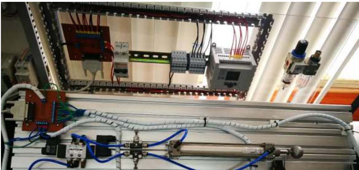
Cableado de los elementos de control
