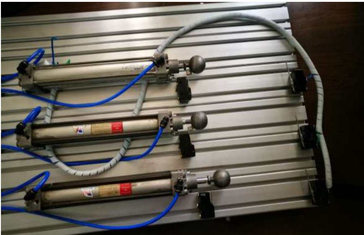
Cableado de los finales de carrera
