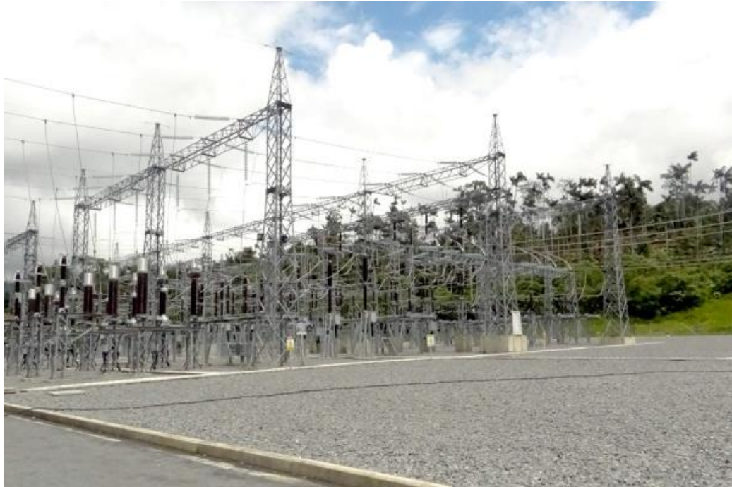
Figura A.5. Patio de Maniobras – Pórticos de entrada y salida. (Fuente: https://www.celec.gob.ec/cocacodosinclair )
