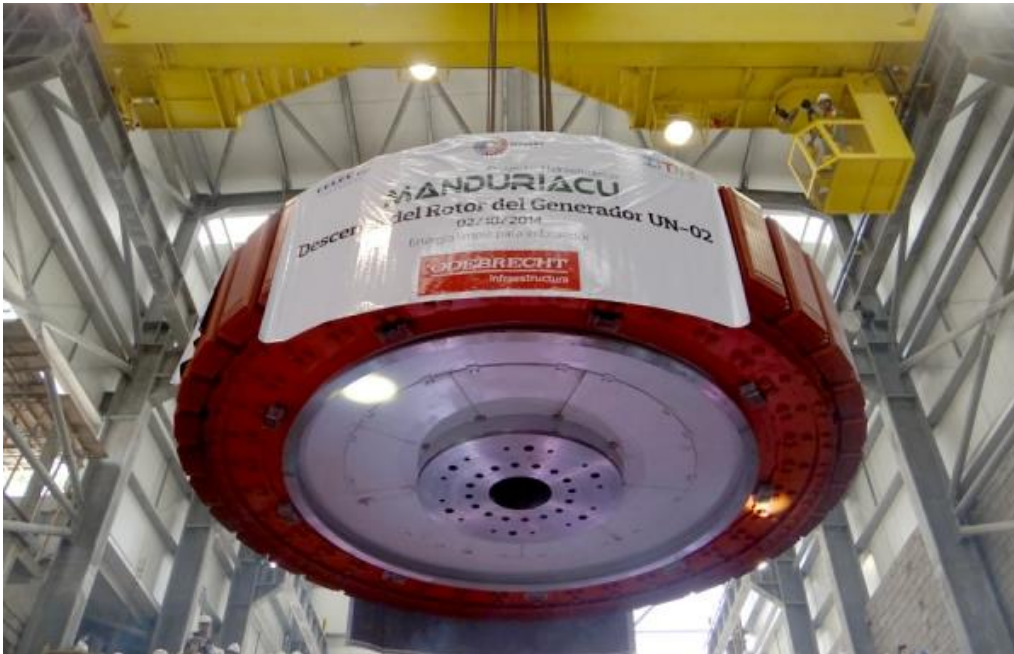
Figura A.4. Desciende rotor del generador en el proyecto hidroeléctrico Manduriacu. (Fuente: https://www.celec.gob.ec/cocacodosinclair )
