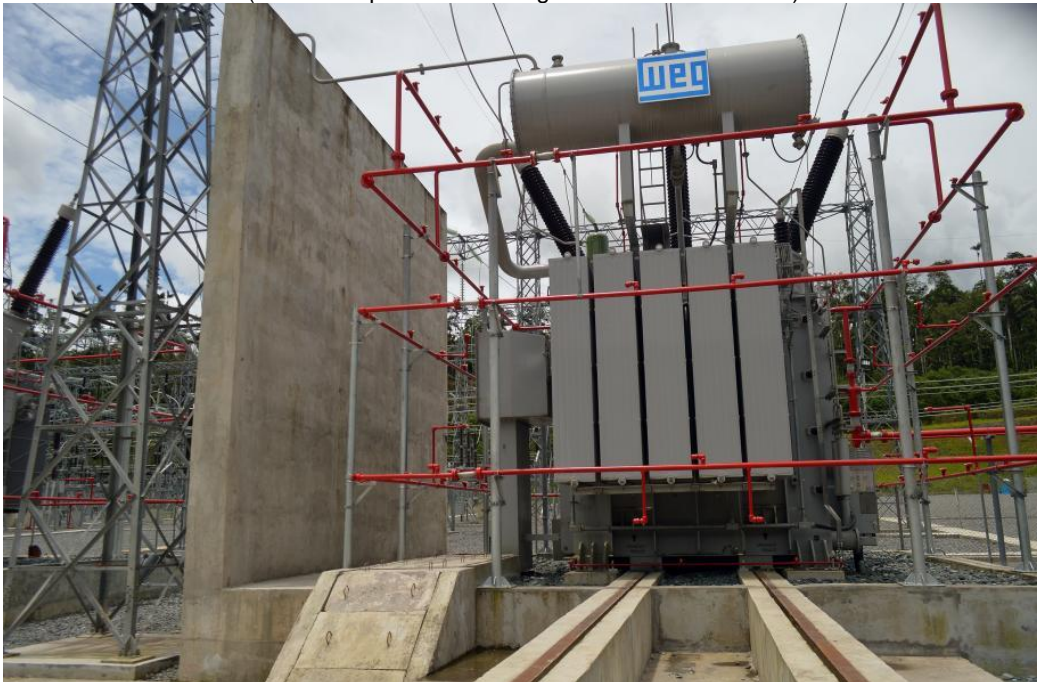
Figura A.6. Transformador trifásico sumergido en aceite 13.8 / 230 / 69 kV 3 devanados 35200 KVA, 500 Msnm exterior.
