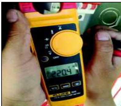
Figura 38: Medición de voltaje; área de parque.
