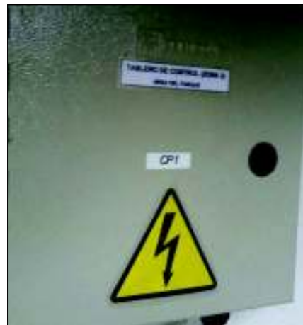
Figura C6: Tablero de control.
