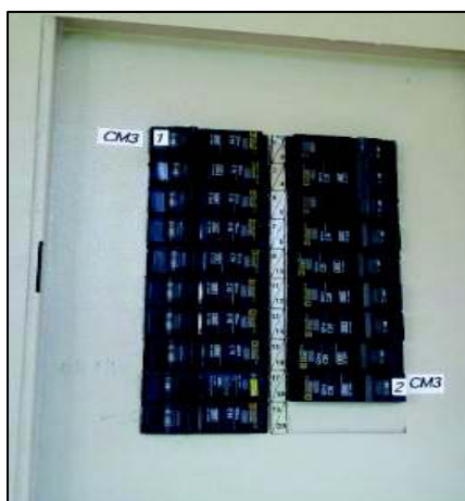
Figura C1: Tablero principal de distribución área central.
