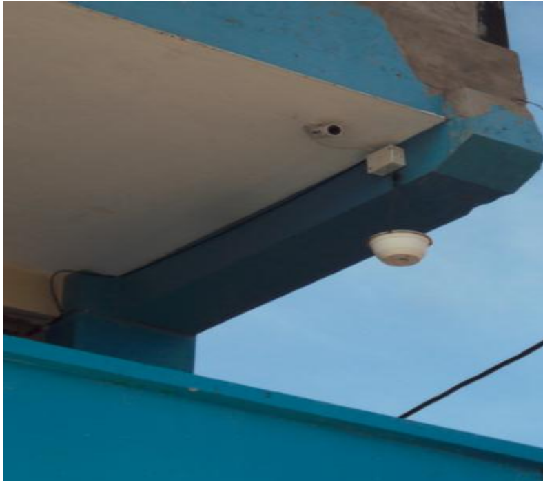
Figura 31. Cámara instalada zona 3.
