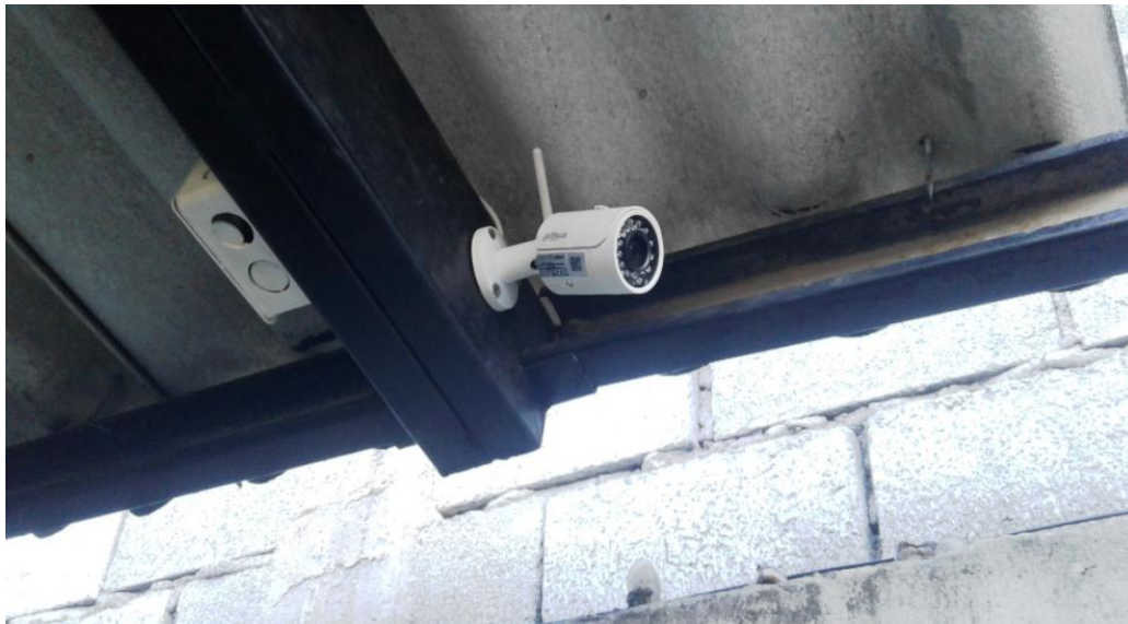
Figura 32. Cámara instalada zona 4.
