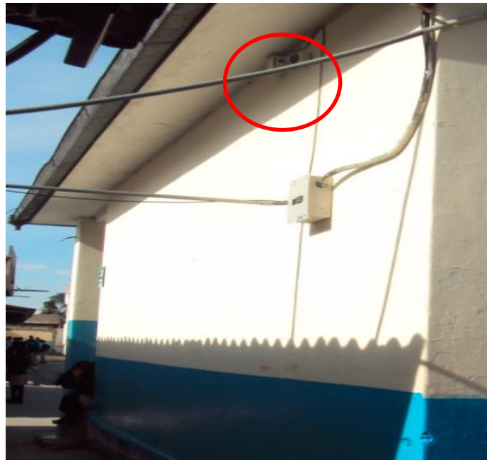
Figura 34. Cámara instalada zona 6.
