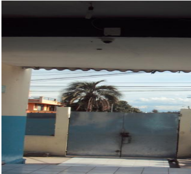
Figura 33. Cámara instalada zona 5.
