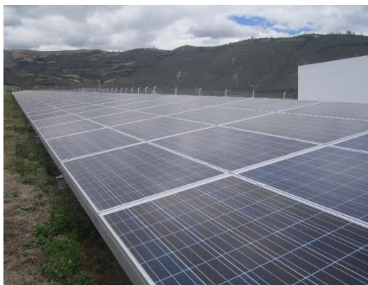
Figura 1.9. Arreglos de los paneles Solares.
