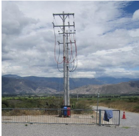
Figura 1.17. Punto de conexión hacia la red pública.
