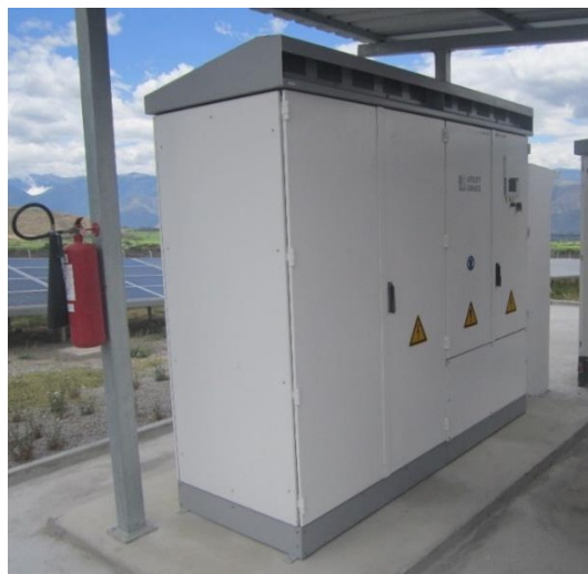
Figura 1.15. Inversor sunny central.
