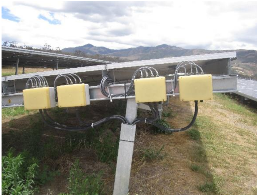
Figura 1.11. Representación in situ de las cajas de conexiones.
