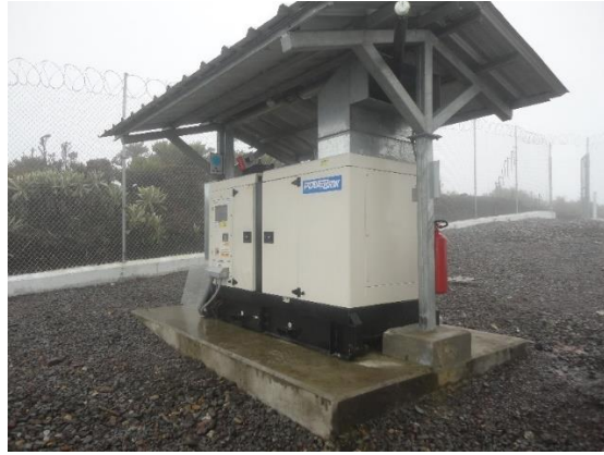
Figura 3.9 Generador diésel Radio Base la Belleza
