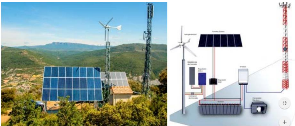
Figura 2.21 Radio bases de Vodafone, España
