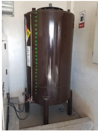
Figura 3.10 Tanque de Reserva de Diesel
