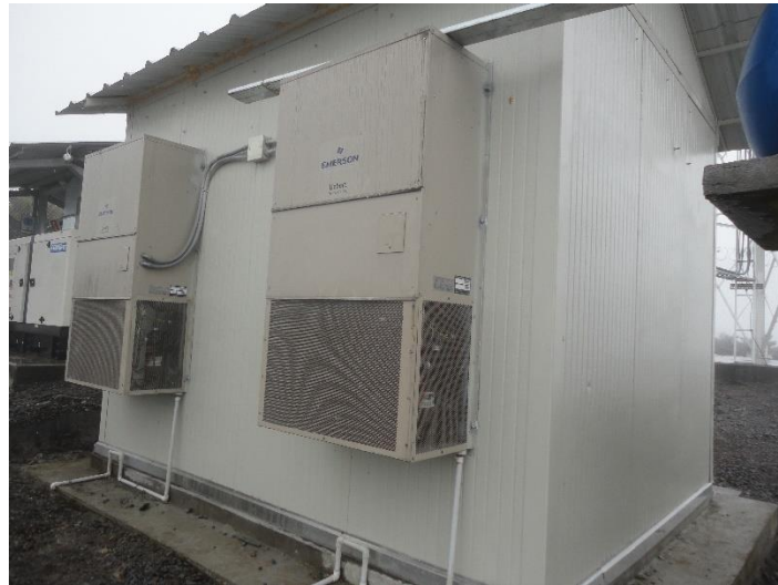
Figura 3.16 Sistema de Aire Acondicionado
