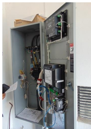
Figura 3.11 Tablero de Transferencia 600 A 220v
