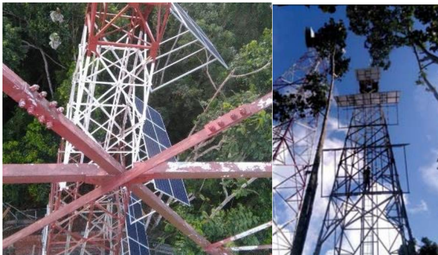
Figura 2.20 Estructura solar en torre de telecomunicaciones selva del Perú
