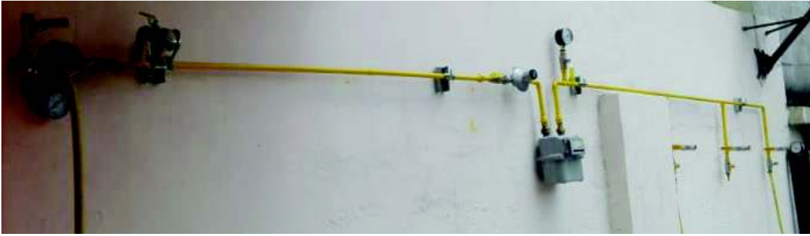
Figura 2.1. Instalación tipo doméstico para mediciones de flujo. (Fuente: propia).
