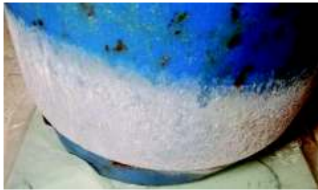
Figura 3.4. Efecto Joule-Thompson en tanque de GLP. (Fuente: propia).
