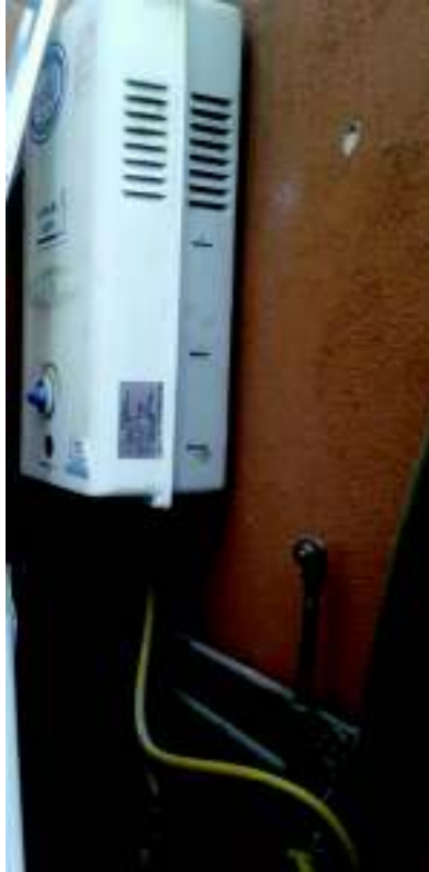
Figura 2.2. Calefón a gas. (Fuente: propia).
