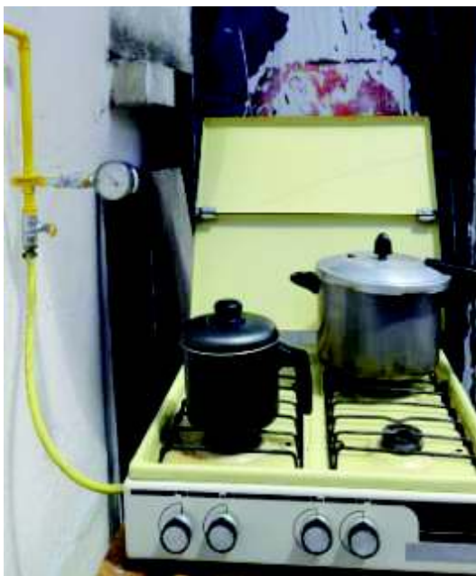
Figura 2.3. Cocineta a gas. (Fuente: propia).
