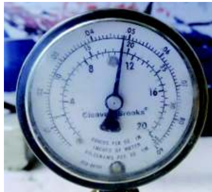
Figura 2.9. Manómetro ubicado antes del último equipo, apreciación 1 pulgH 2 O. (Fuente: propia).
