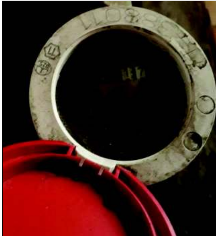
Figura 2.2. Contador de ACS individual. (Fuente: Edificio Kitzia)
