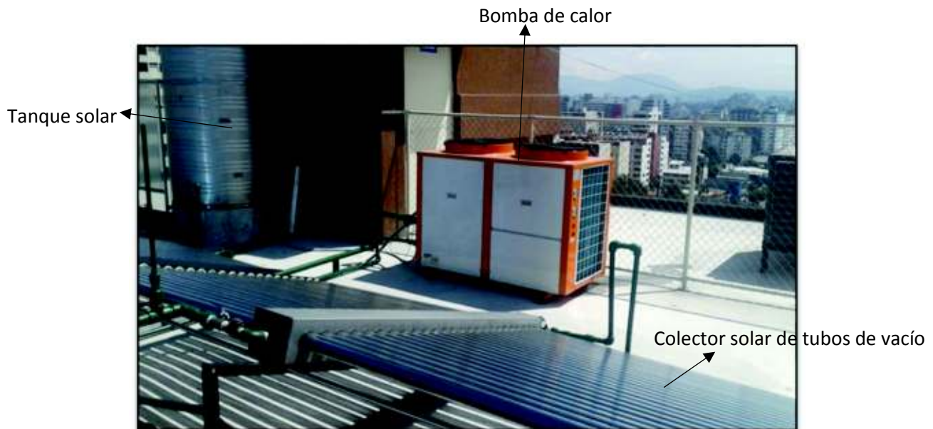
Figura 1.15. Instalación Edificio Estrella IX. (Fuente: Propia)
