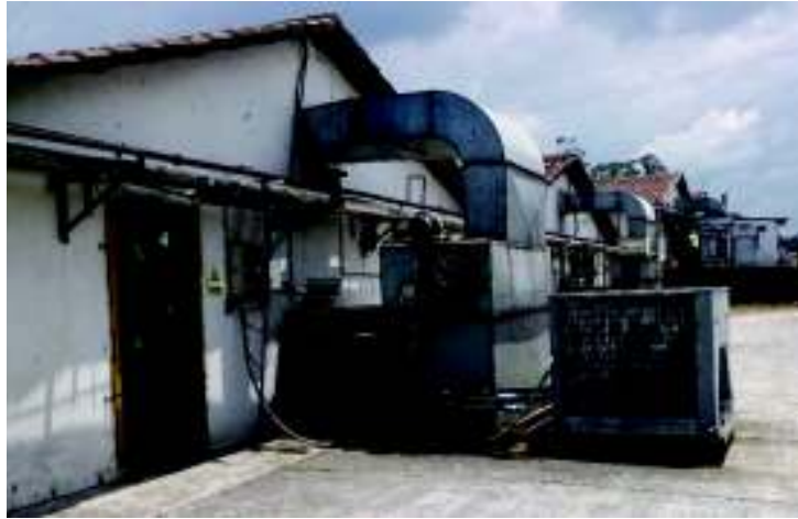
Figura1.6. Unidades de tratamiento de aire [2].
