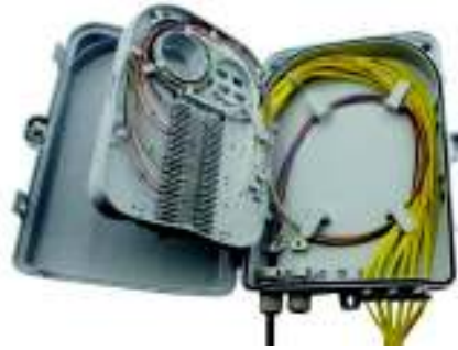
Figura 2.10. Cajas de empalmes con espacio para reservas.
