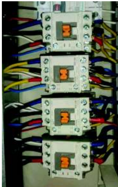
Figura 8 Contactores de 22 amperios.
