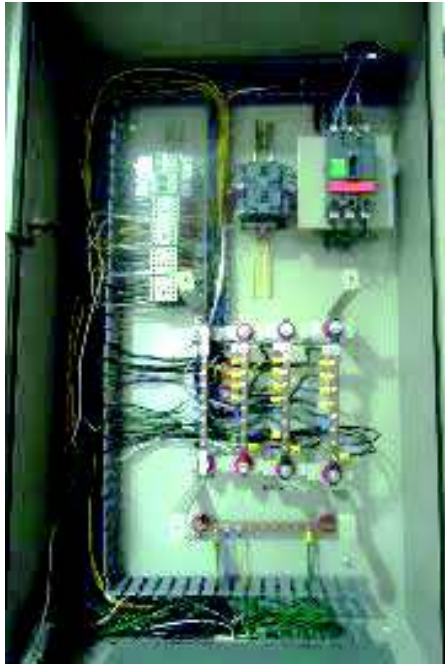
Figura 4 Interior del tablero sin protecciones
