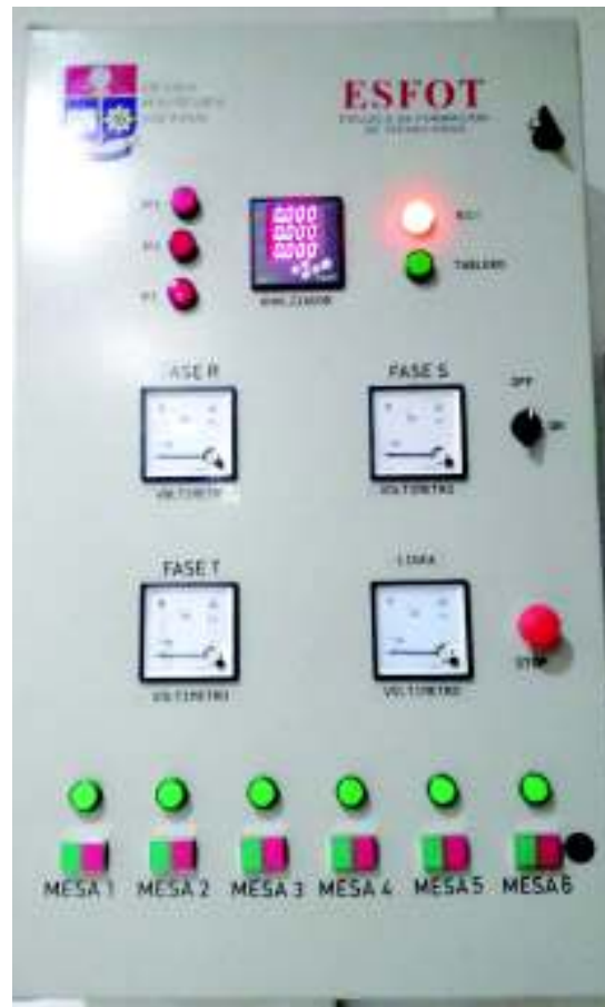
Figura 1 Tablero de distribución
