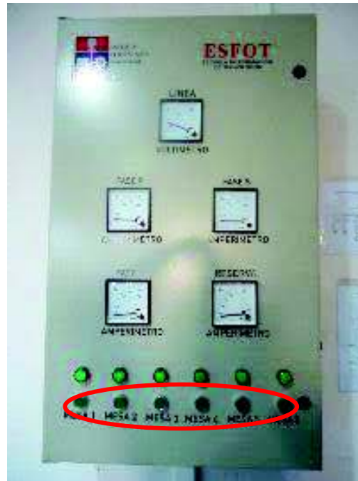
Figura 3 Tablero condiciones iniciales
