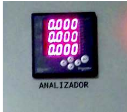
Figura 21 Analizador de red.
