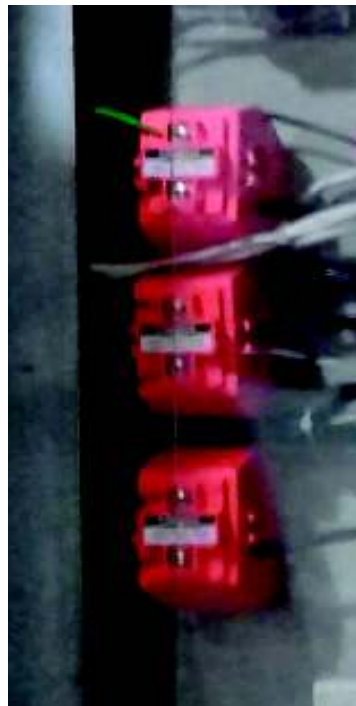
Figura 24 Transformador de corriente.
