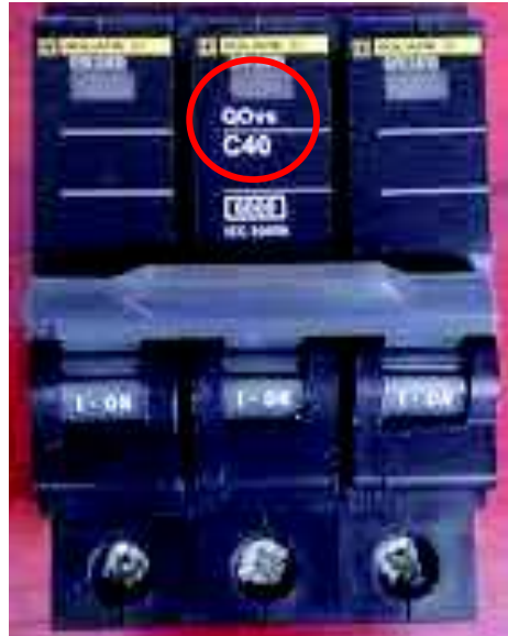
Figura 2 Breaker de alimentación del tablero
