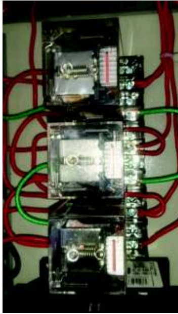
Figura 15 Relés de control de protección de falta de fase.
