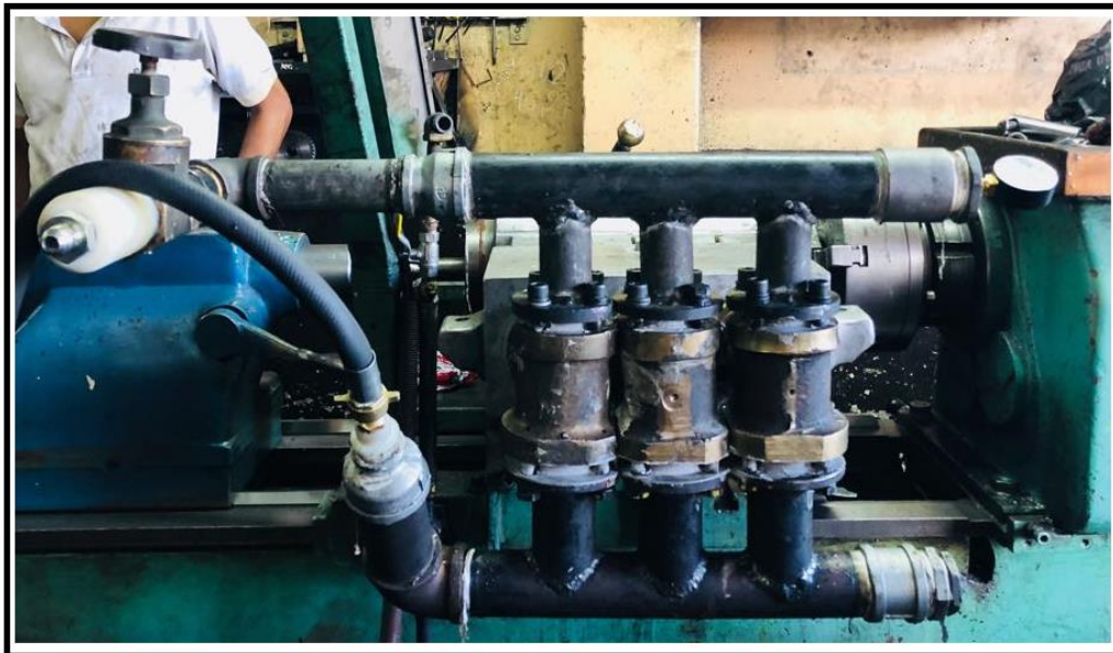
Figura 2.46. Bomba triplex vista lateral. (Fuente propia)
