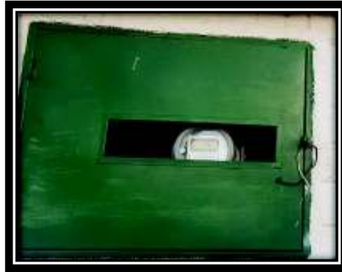
Figura 3.6 Contador de energía A.
