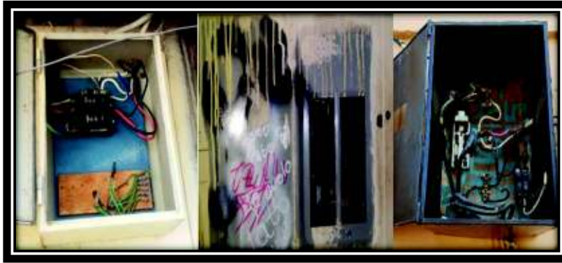
Figura 3.21 Centros de Carga en mal Estado.
