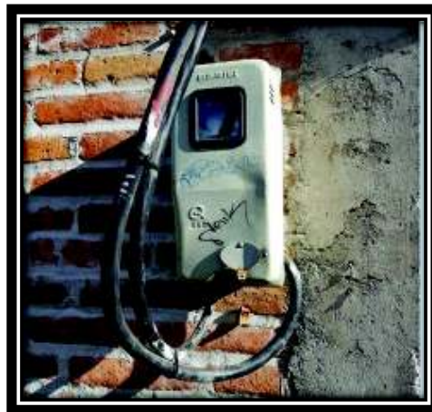
Figura 3.7 Contador de energía B.
