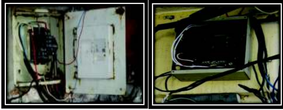
Figura 3.20 Tableros de distribución del COTAESG.
