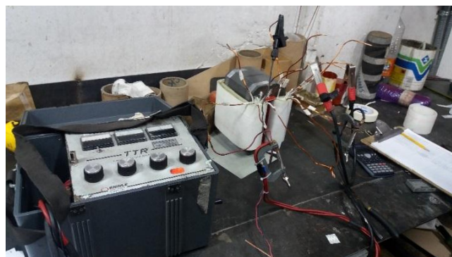
Figura 4.16. Prueba de relación de transformación mediante el equipo TTR
