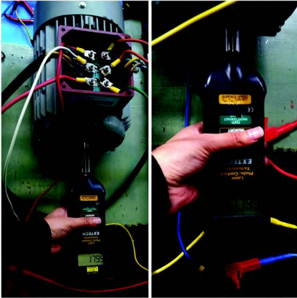
Figura 2.12. Velocidad en revoluciones por minuto del motor trifásico de inducción de 2 hp
