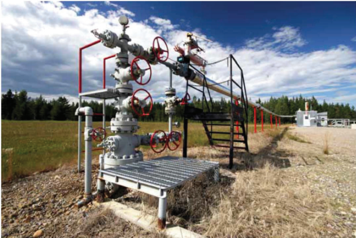
Figura 1.6. Cabeza de pozo instalada. (Fuente: (Centrilift, B. H., 2008))
