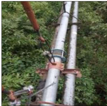
Figura 18. Tuberías expuestas del sistema de aducción
