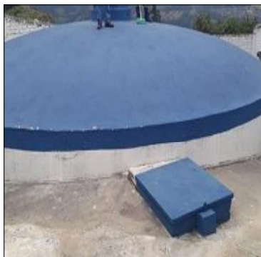
Figura 21. Tanque de almacenamiento correspondiente a la planta de tratamiento
