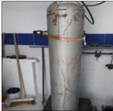
Figura 20. Cloro gas correspondiente a la planta de tratamiento
