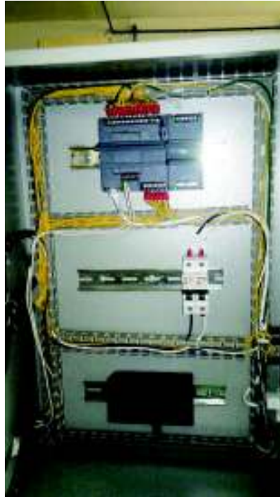
Figura 3. 7 – Disposición en el tablero del módulo SM 1222.
