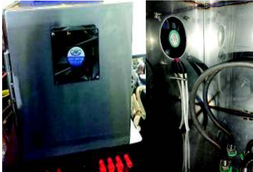
Figura 3. 62 – Montaje de Ventiladores: a) Vista externa; b) Vista interna.
