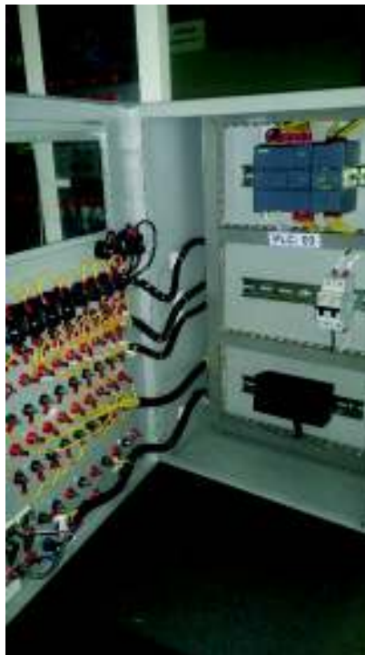
Figura 3. 13 – Cubierta de canaletas y aislamiento de cables visibles
