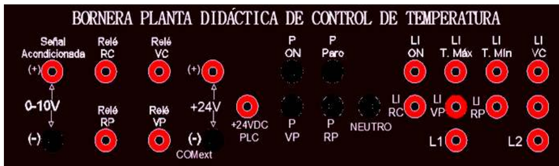
Figura 3. 65 – Bornera de la Planta Didáctica de Control ON-OFF de temperatura
