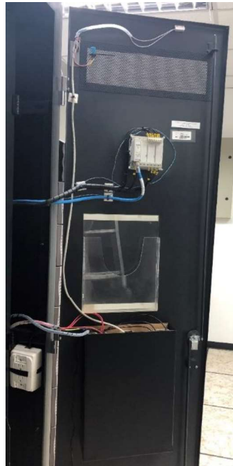
Figura 3.10. Prototipo implementado con los sensores conectados a las líneas que alimentan el Data Center .
