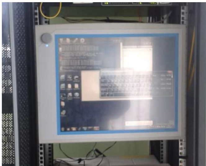
Figura 2.13. Pantalla táctil operativa de la subestación EL RETORNO
