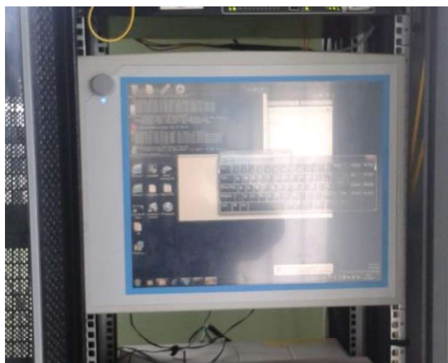
Figura 2.41. Pantalla que se encuentra en las instalaciones de la subestación EL RETORNO
