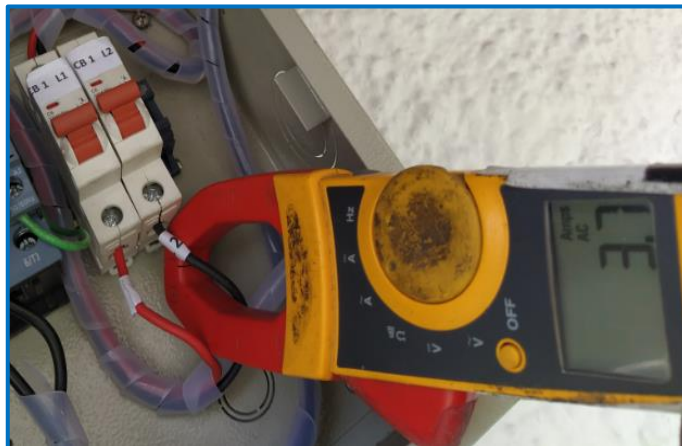
Figura 21. Medición de corriente zona 4.
