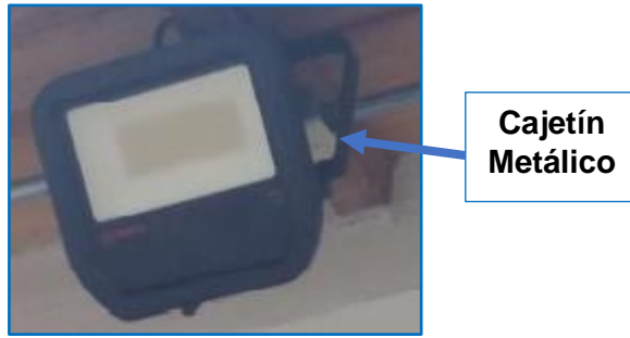
Figura D.11. Reflectores Tipo LED Fuente. (Propia)
