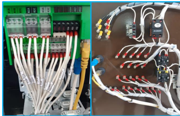
Figura 3.18 Etiquetado y cableado con elementos de sujeción y protección.
