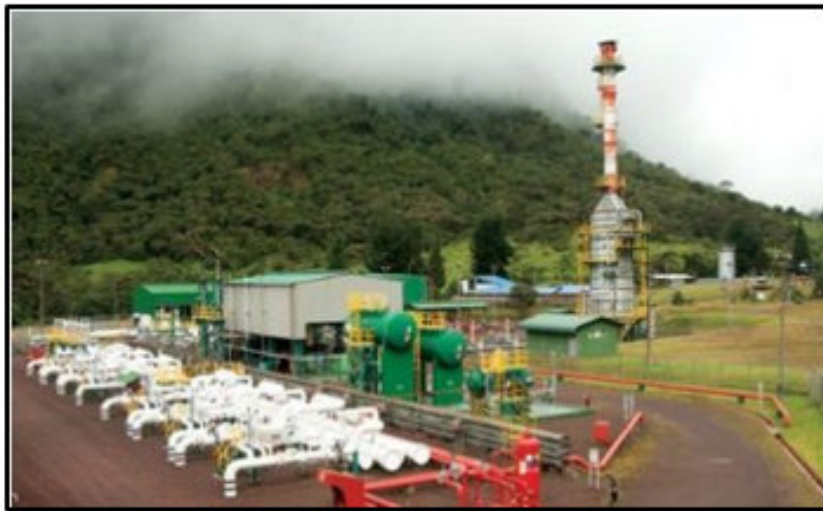
Figura 1.2: Estación Páramo Fuente: www.ocpecuador.com
