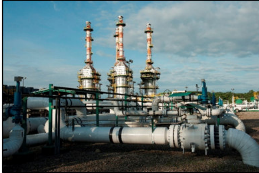
Figura 1.1: Estación de bombeo Amazonas Fuente: www.ocpecuador.com
