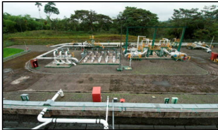
Figura 1.3: Estación Reductora de Presión Puerto Quito
