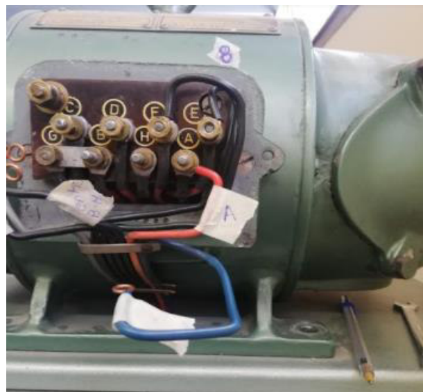
Figura 4.1. Identificación y etiquetado de cableado en la máquina.
