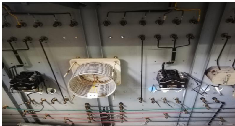
Figura 4.16. Cambio de reóstatos en el módulo móvil 1.
