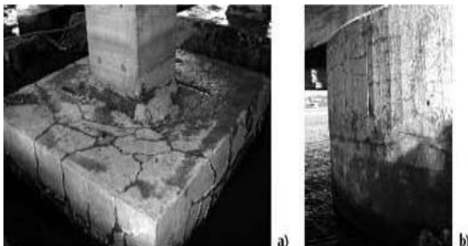
Figura 2.1 Manifestaciones de reacción álcali-sílice. a) Cimentación b) Pila de puente.
