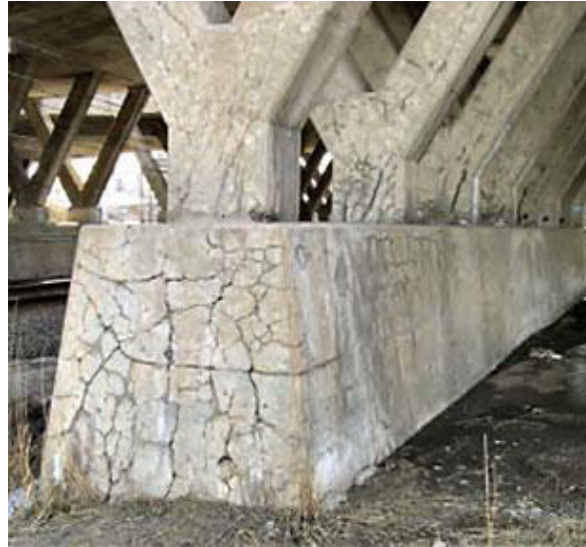
Figura 2.3 Reacción álcali-sílice presente en cimentación de puentes, California, EE. UU.
