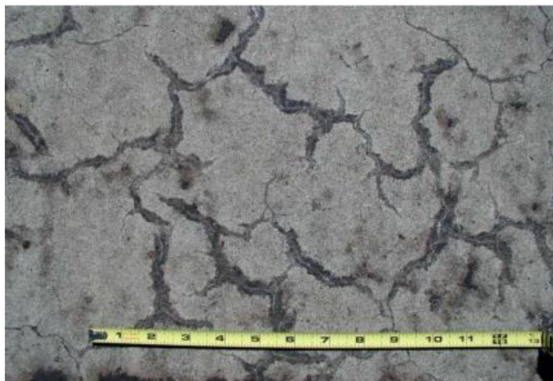
Figura 2.12 Exudación del gel álcali-sílice a través de las grietas mapeadas.
