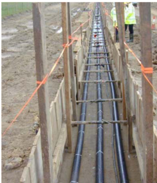
Figura 3.6. Ejemplo de cables directamente enterrados [21]
