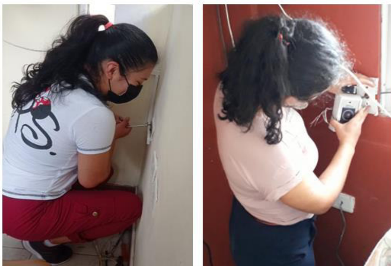
Figura 3.14 Instalación del pulsador y botón no-touch
