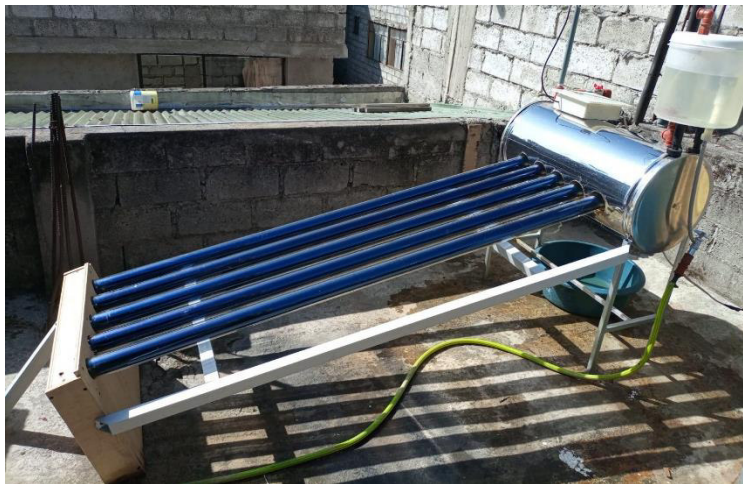
Figura 3.13 Módulo termosolar de agua caliente terminado
