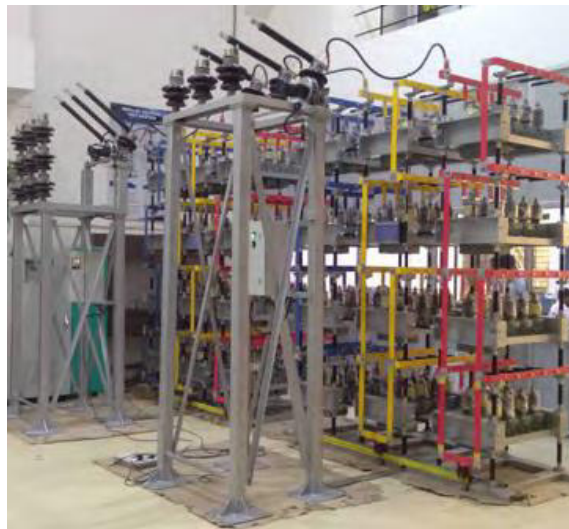
Figura 3. 27. Banco de condensadores de compensación de energía [31]
