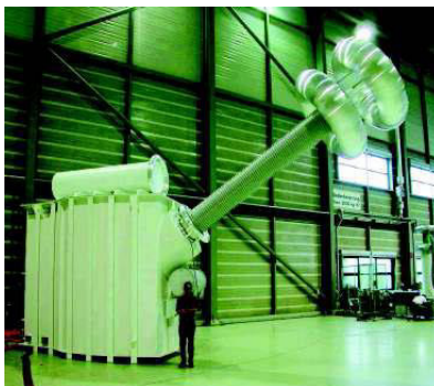
Figura 3. 9. Transformador tipo tanque. 750 kV/2100 kVA. [14]
