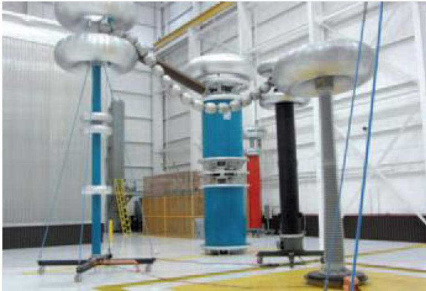
Figura 1.8. Transformador tipo cascada en caja aislante. [14]
