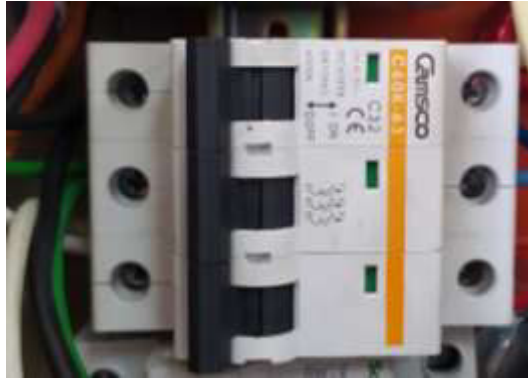
Figura E.4. Breaker de alimentación trifásico de la red
