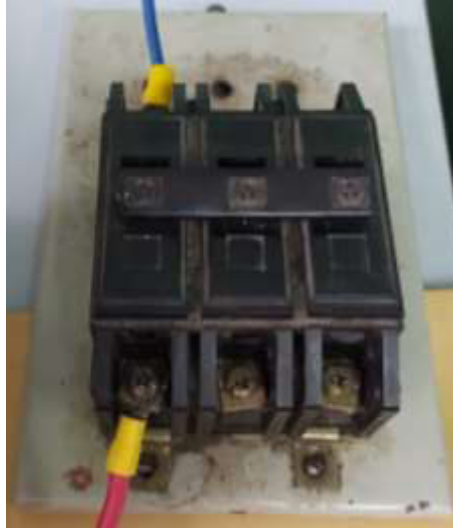
Figura E.2. Breaker de encendido para armadura del motor de corriente continua
