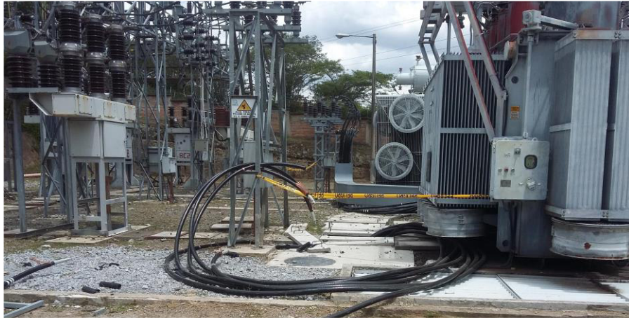
Figura 4.4 Transformador de potencia “extremo REMOTO de prueba” [Elaboración Propia].
