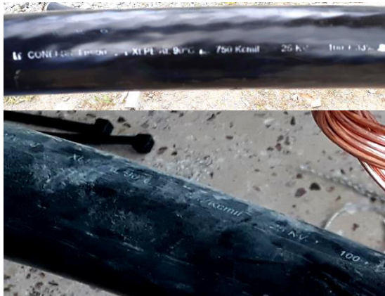
Figura 4.6. Características del cable descritos en la chaqueta [Elaboración Propia].
