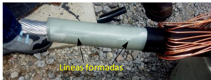
Figura 4.17. Líneas formadas en el extremo lejano del cable fallado [Elaboración Propia].
