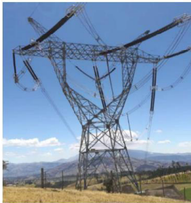
Figura 4.5. Estructura de transposición para línea de transmisión 500 kV [28].
