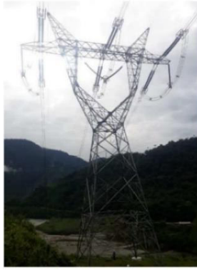
Figura 4.4. Estructura de retención para línea de transmisión 500 kV [28].
