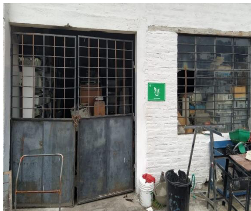
Figura 8. Vista frontal de la entrada al galpón 2 de la bodega San bartolo. Se puede identificar el mal estado de la puerta e inclusive la ventana rota.
