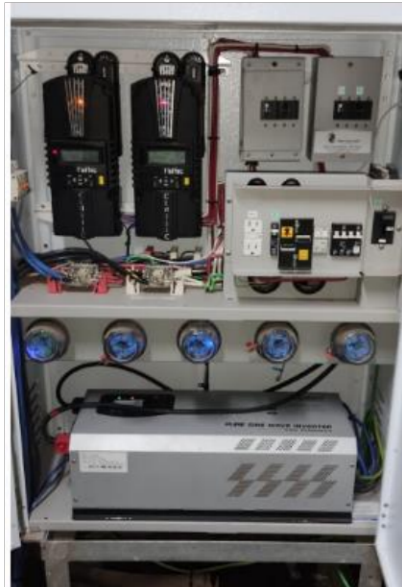
Figura 3.5. Conexión en el tablero de conversión de energía.
