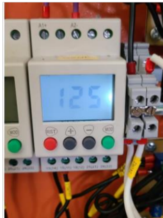
Figura 3.15. Comprobación de un nivel adecuado de voltaje proveniente del generador.
