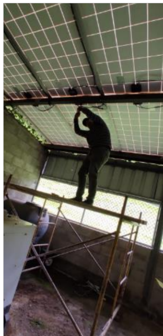
Figura 5.25. Mediciones previas de voltaje en los paneles para identificar la polaridad de sus terminales en cada uno de ellos para su posterior conexión.
