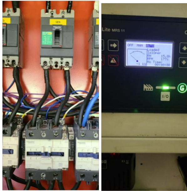
Figura 3.37. Generador eléctrico suministrando energía a la finca al ser activado remotamente.
