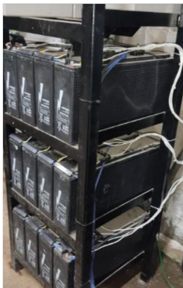
Figura 3.6. Conexión en el banco de baterías.
