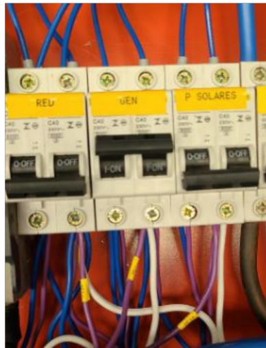
Figura 3.13. Breaker de los paneles solares y red eléctrica deshabilitados simulando falla.
