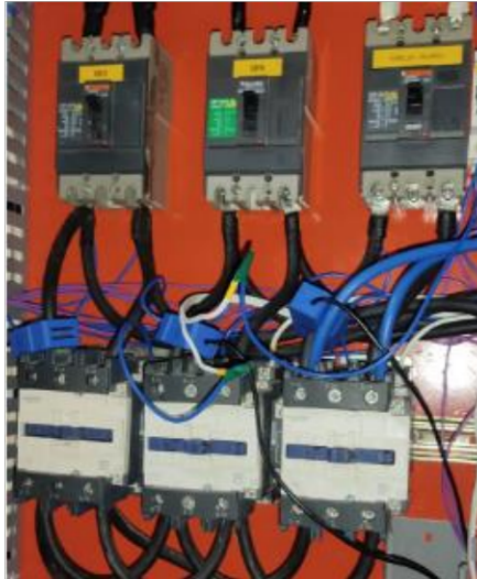
Figura 3.11. Contactor de red activado.
