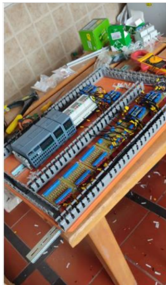
Figura 5.22. Colocación del controlador y sus módulos de expansión, los relés de fase, las placas de divisoras de voltaje y los multiplexores en el tablero eléctrico.
