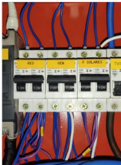
Figura 3.8. Breakers de las tres fuentes en condiciones normales.
