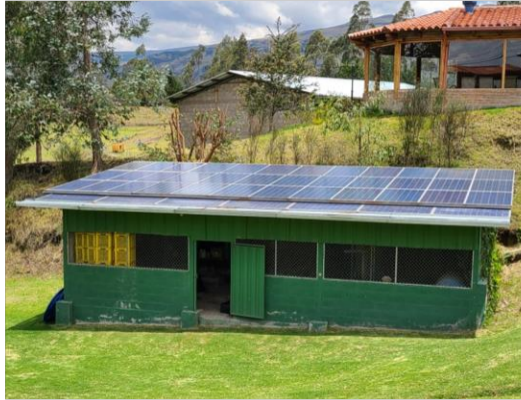
Figura 2.3. Paneles solares de la finca.
