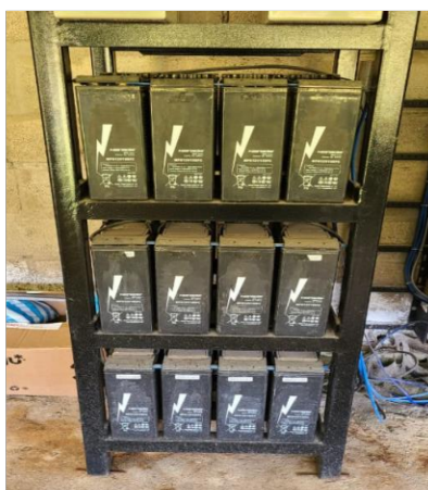
Figura 2.9. Baterías presentes en el sitio.
