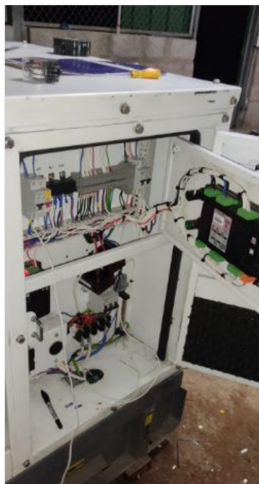
Figura 3.4. Conexión en el módulo de control del generador.
