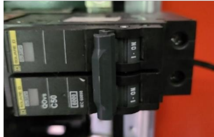
Figura 5.11. Breaker para entrada AC.
