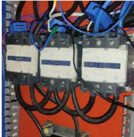
Figura 3.9. Contactor del sistema fotovoltaico activado.
