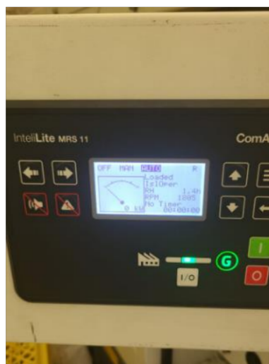
Figura 3.17. Pantalla del módulo de control del generador en modo automático.
