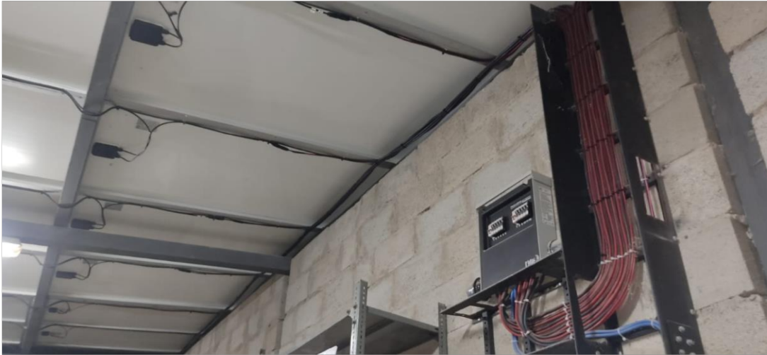
Figura 3.7. Conexión en los paneles solares.
