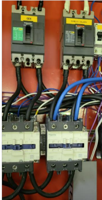
Figura 3.33. Sistema solar suministrando energía a la finca.
