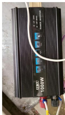
Figura 5.18. Inversor para el PLC.
