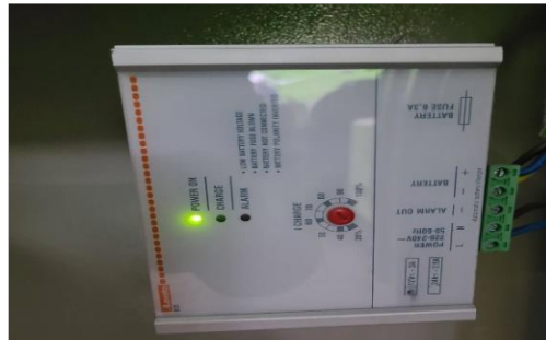
Figura 5.7. Cargador de la batería del generador.
