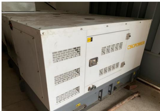
Figura 2.10. Generador presente en el sitio sin uso.
