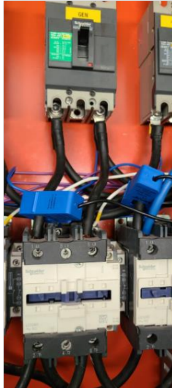
Figura 3.16. Contactor de generador eléctrico activado.
