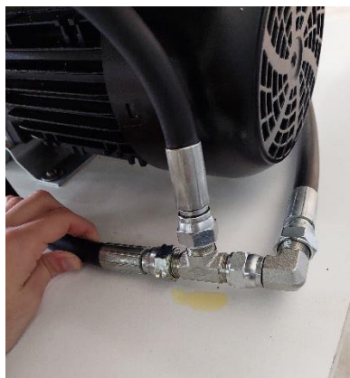
Figura 3.9 Problema de fuga.
