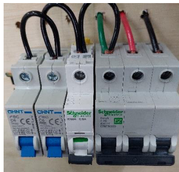
Figura 3.7 Termomagnéticos de control y unidad hidráulica.
