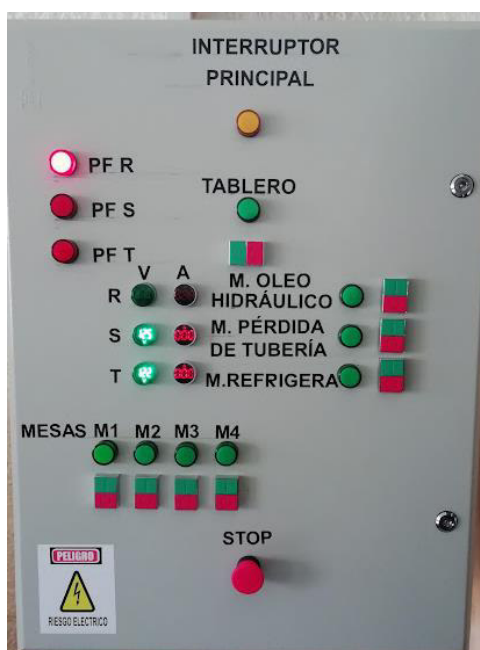
Figura 3.32 Encendido de la luz roja de pérdida de fase.
