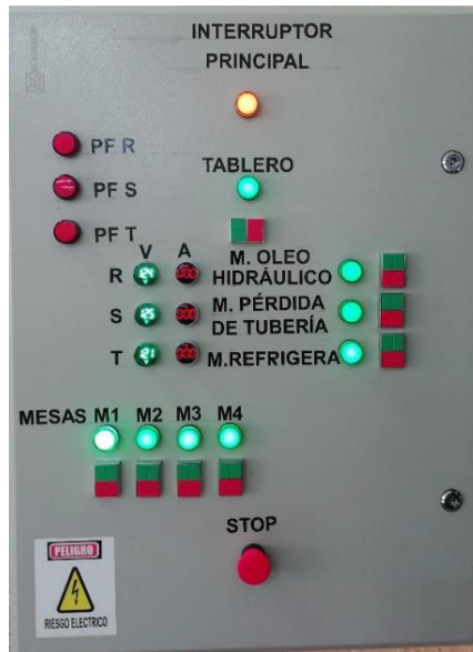
Figura 3.28. Etiquetas exteriores del tablero de alimentación
