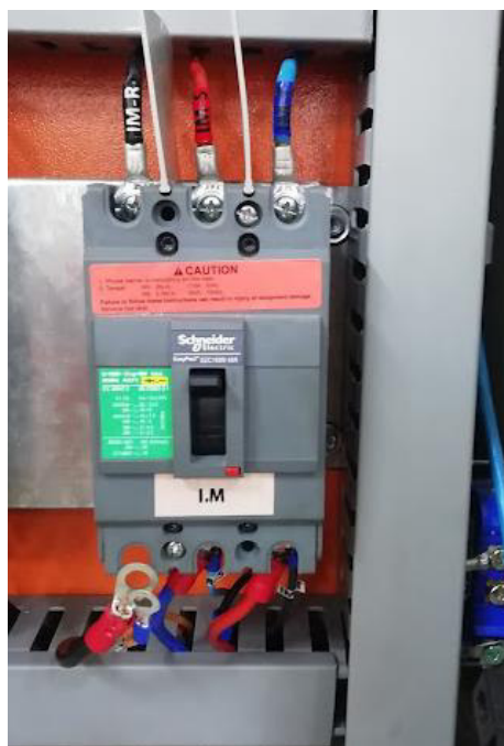
Figura 3.31 Desconexión de la fase R
