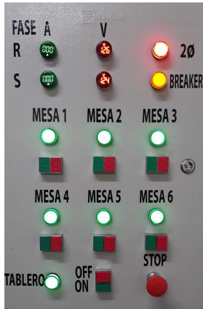
Figura 2.17 Etiquetado de la parte externa del tablero de control
