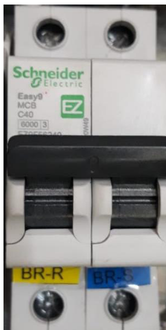
Figura 2.4 Protección termomagnética bipolar de 40 (A)
