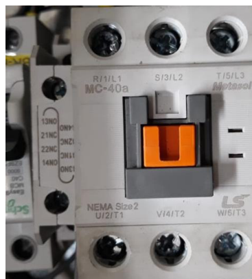
Figura 2.5 Contactor AC-3 40 (A) para la energización del tablero
