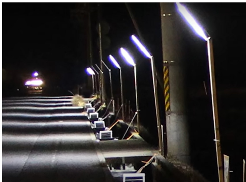
Figura 1.5 Alumbrado público con micro generadores, [6].
