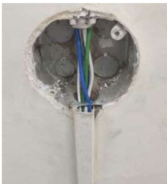
Figura 3.10. Estado actual del cableado eléctrico del laboratorio.
