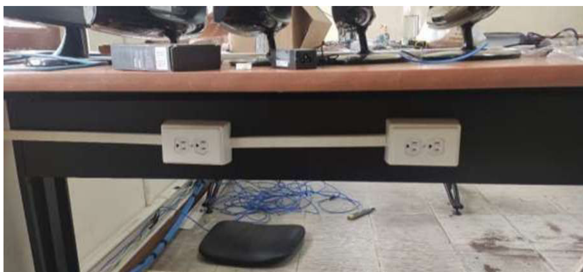
Figura 3.12. Estado actual de los tomacorrientes
