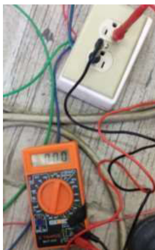
Figura 3.3. Tomacorrientes sin energía debido al mal estado
