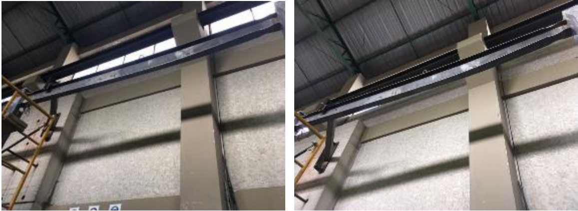
Figura 68. Pandeo local en viga superior Elaboración: Jorge Martínez y Darío Pallares
