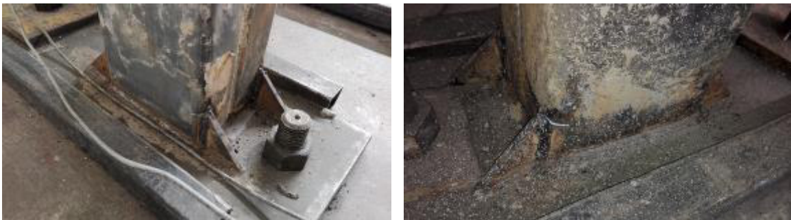
Figura 89. Agrietamiento en rigidización de placa base Elaboración: Jorge Martínez y Darío Pallares
