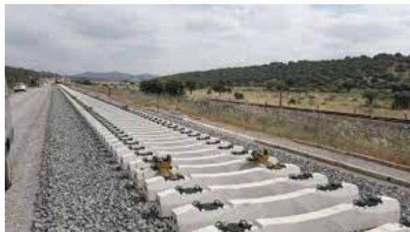
Figura 1.11. Traviesas de hormigón/bloque, tipo monobloque. (Fuente: ICPA,2013)
