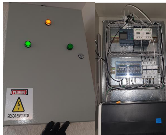
Figura 3.65 Tablero de control 2 en Laboratorio 35 (TDC2LB35).
