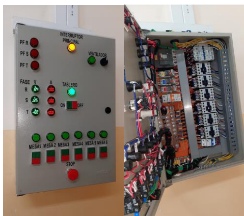
Figura 3.73 Tablero de control 1 en Laboratorio de Mecánica (TDC1LBMC).
