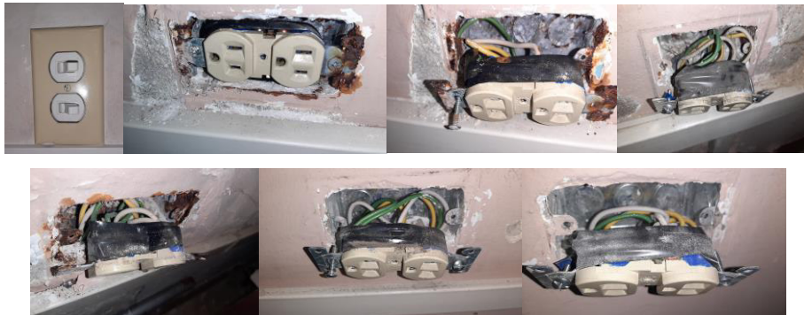
Figura 3.36 Interruptor y tomas del Centro de Cultura Física
