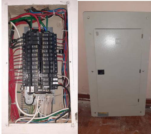
Figura 3.18 Tablero de distribución principal de la Of7.
