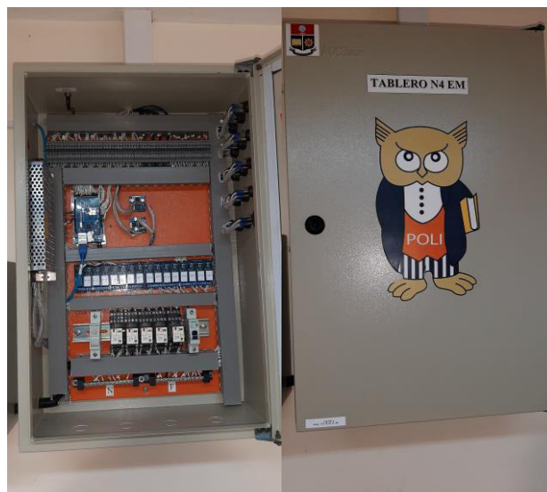
Figura 3.13 Tablero de control del aula 26.
