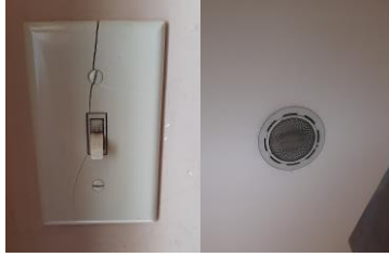
Figura 3.28 Interruptor y luminaria de la bodega 9.
