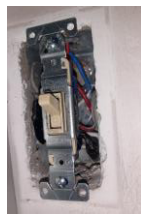
Figura 3.7 Interruptor de la bodega 11 en el aula 32.
