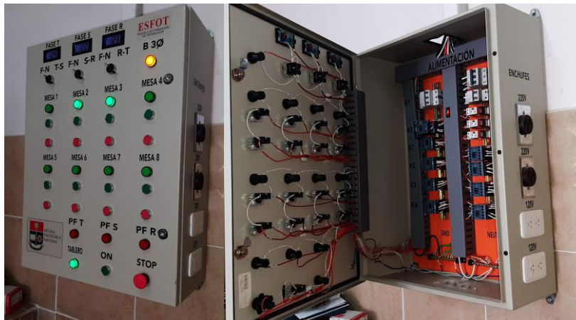
Figura 3.71 Tablero de control 5 en LTI (TDC5LBLTI).
