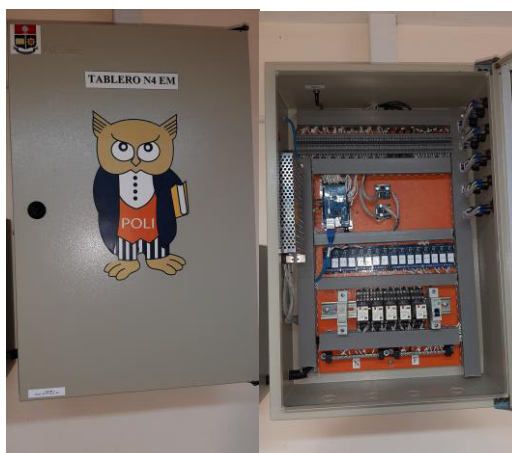
Figura 3.63 Tablero de control 1 en Aula 26 (TDC1AE26).
