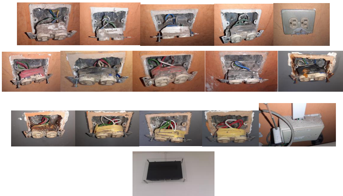
Figura 3.37 Tomas del pasillo y cajas de conexión.
