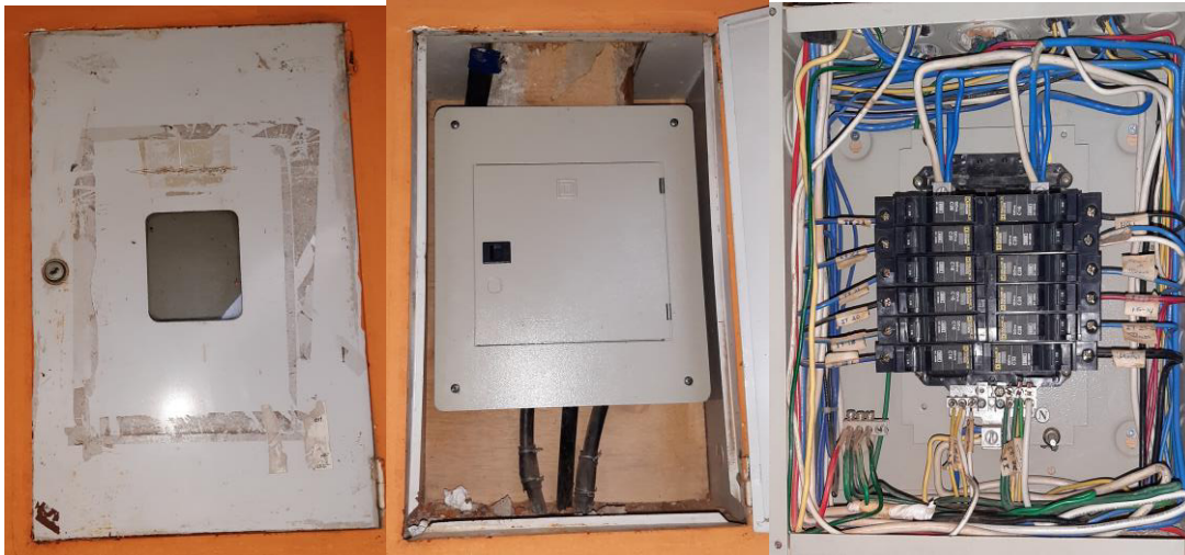
Figura 3.54 Tablero de distribución secundario 1 en pasillos (TDS1PSAE).
