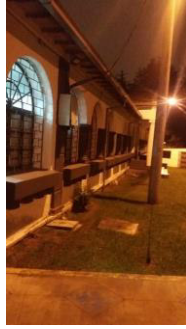
Figura 3.40 Luminarias reflectoras de los exteriores apagadas en la noche.
