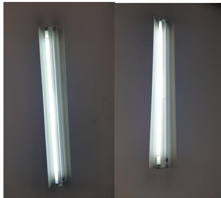
Figura 3.21 Luminarias 2 y 5 de la Of6.
