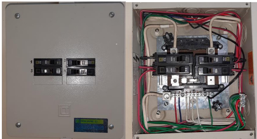
Figura 3.80 Tablero de distribución secundario 1 en el Laboratorio de TICS 22 B (TDS1LB22B).
