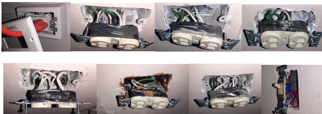
Figura 3.17 Tomas e interruptor de la Of7.
