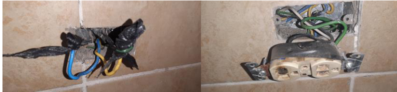
Figura 3.24 Caja de conexión y toma del cuarto baños 6.
