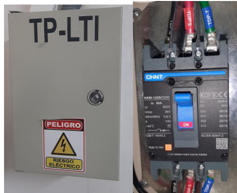
Figura 3.50 Tablero de distribución secundario 1 en Oficina 7(TDS1OF7).
