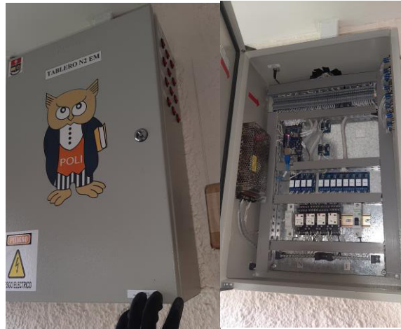
Figura 3.66 Tablero de control 3 en Laboratorio 35 (TDC3LB35).
