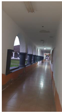
Figura 3.39 Luminarias averiadas en los pasillos.
