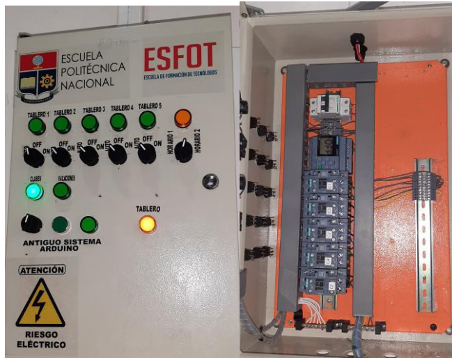
Figura 3.74 Tablero de control 1 de Bodega 10 en el Laboratorio de Mecánica (TDC1BD10).
