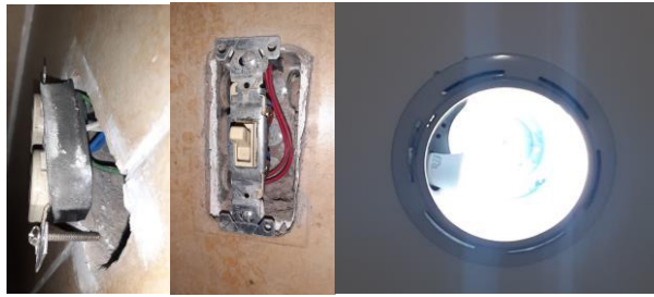
Figura 3.22 Tomas e interruptor de la Of6.
