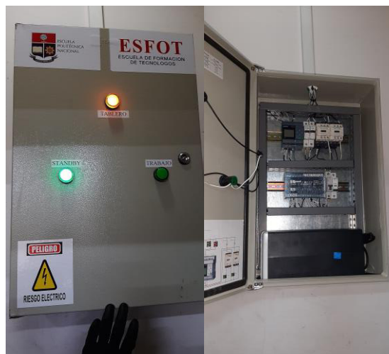
Figura 3.75 Tablero de control 2 de Bodega 10 en el laboratorio de Mecánica (TDC2BD10).
