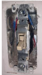
Figura 3.27 Interruptor de la bodega 12.
