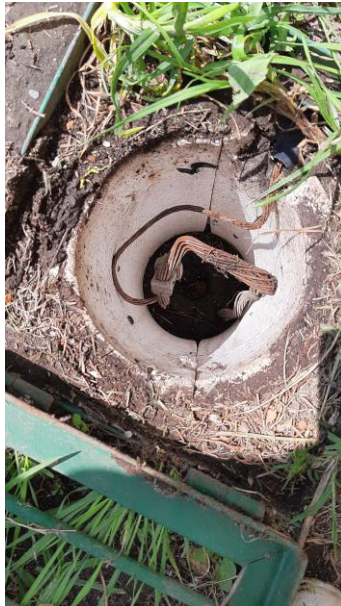
Figura 3.47 Puesta a tierra del tablero de control de la distribución de energía en el Laboratorio de Tecnología Industrial.
