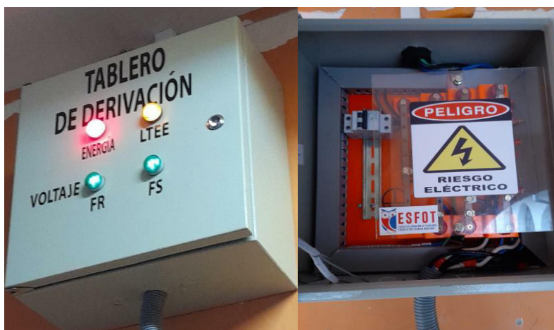
Figura 3.57 Tablero de derivación 1 en pasillos (TDD1PSAE).
