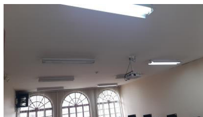
Figura 3.33 Luminarias laboratorio de TICS 22B.
