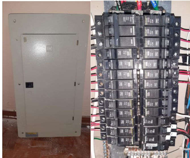
Figura 3.49 Tablero de distribución principal 1 en Oficina 7(TDP1OF7).
