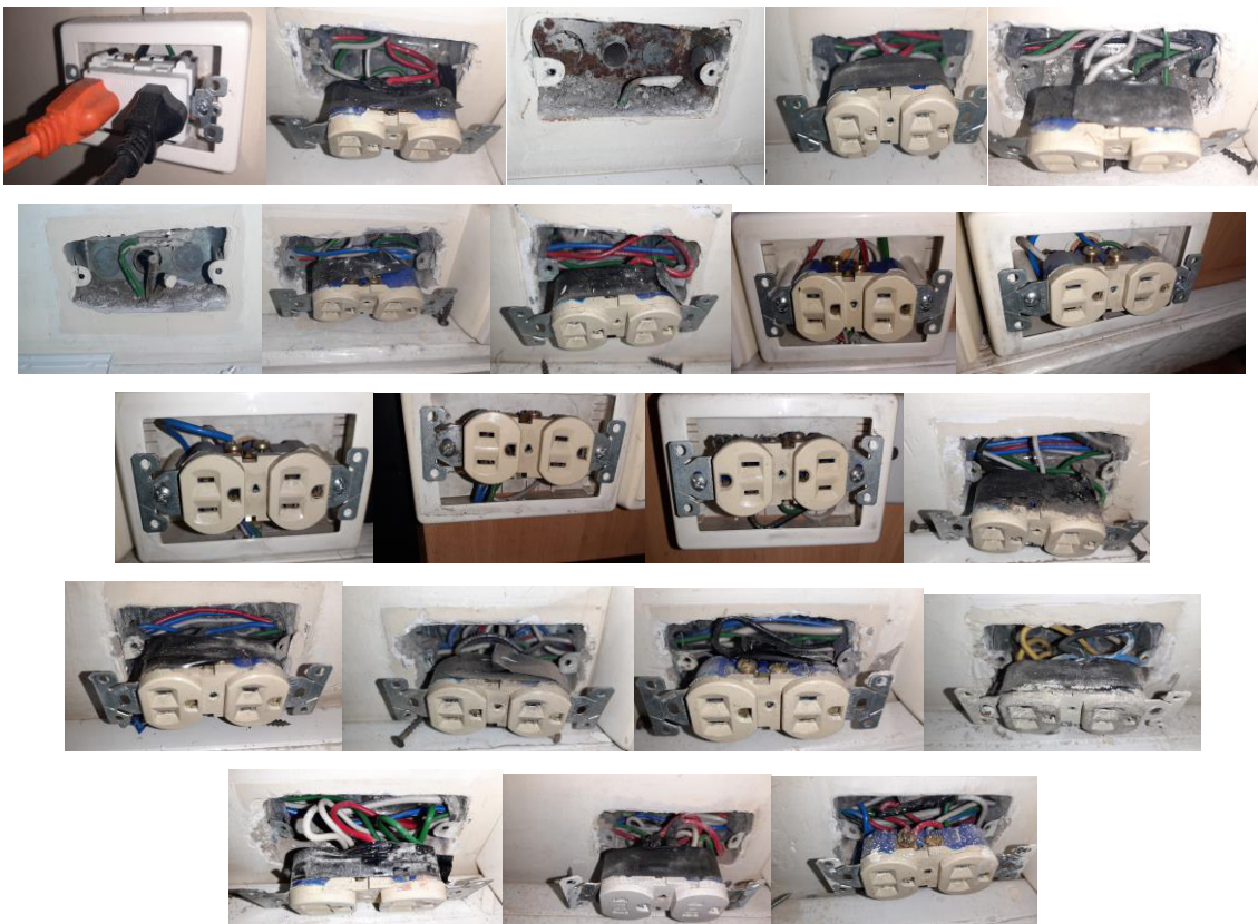
Figura 3.31 Tomas y cajas de conexión del Laboratorio de Eléctrica y Electrónica.
