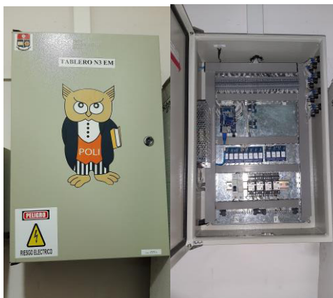
Figura 3.76 Tablero de control 2 en Bodega 10 (TDC2BD10).
