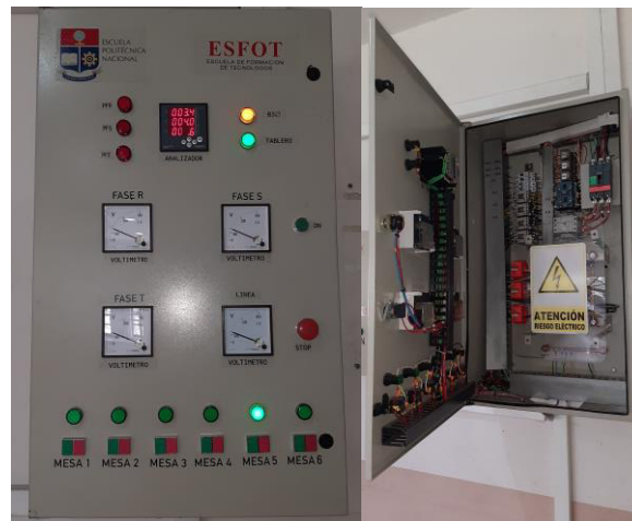
Figura 3.68 Tablero de control 2 en LTI (TDC2LBLTI).
