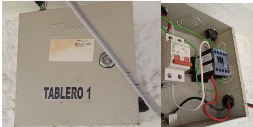
Figura 3.52 Tablero de control 1 en Exteriores (TDC1EXAE).
