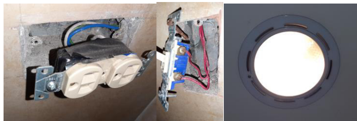
Figura 3.19 Toma, interruptor y luminaria del baño 8 en Of7.
