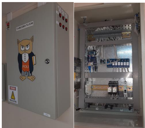
Figura 3.62 Tablero de control 1 en Aula 38 (TDC1AE38).
