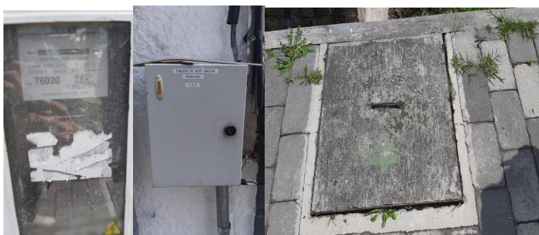
Figura 3.42 Medidor 2 tablero principal 2 y su puesta a tierra.
