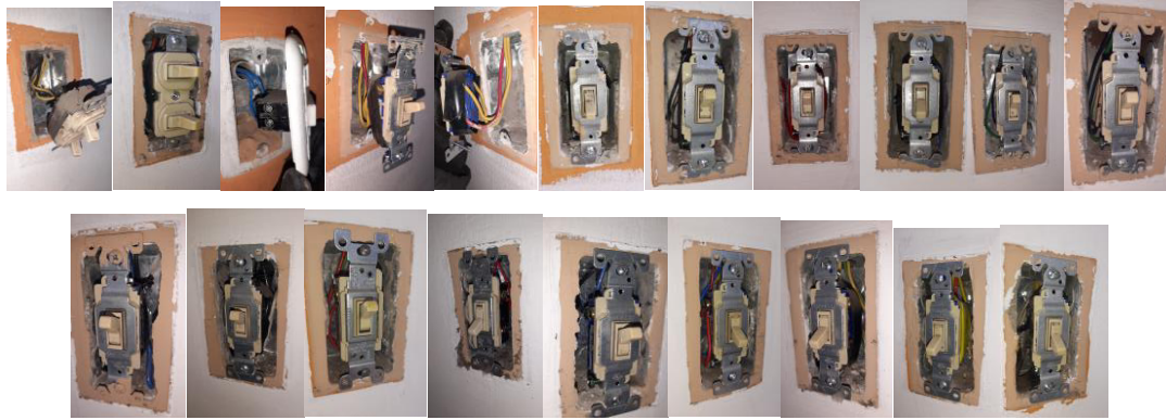
Figura 3.38 Interruptores dobles y simples del pasillo.
