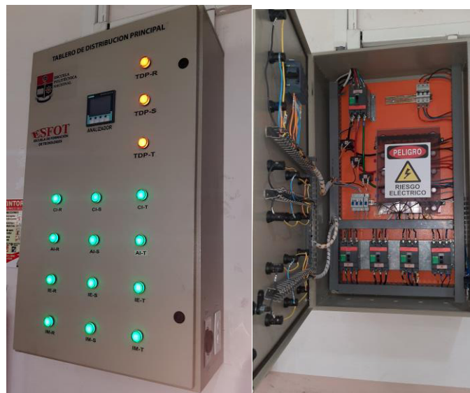
Figura 3.70 Tablero de control 4 en LTI (TDC4LBLTI).
