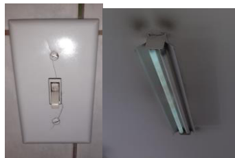
Figura 3.25 Interruptor simple y luminaria del cuarto de baños 5.
