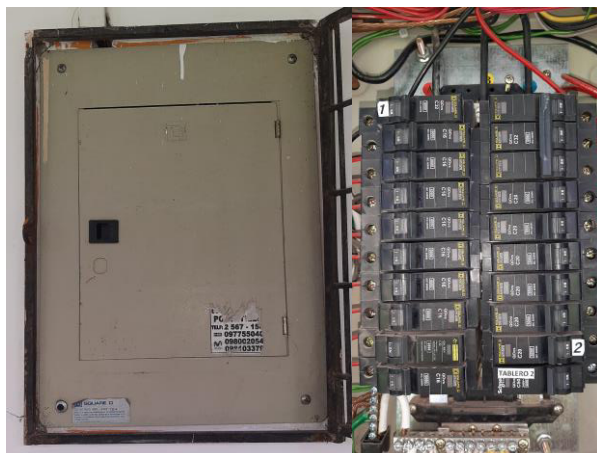
Figura 3.55 Tablero de distribución secundario 2 en pasillos (TDS2PSAE).
