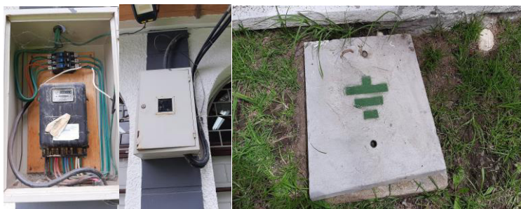
Figura 3.41 Medidor 1 y su puesta a tierra.
