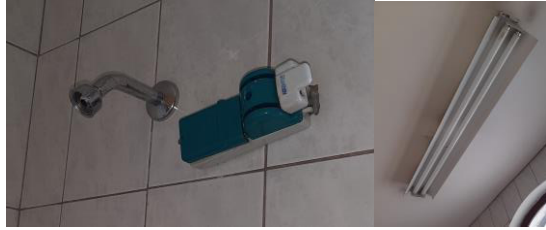
Figura 3.26 Interruptor de cuchillas para ducha y luminaria de la bodega 8 en el cuarto de baños 5.
