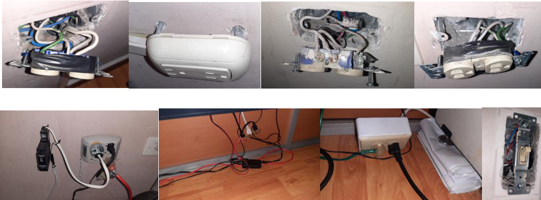
Figura 3.20 Tomas e interruptor de la Of6.
