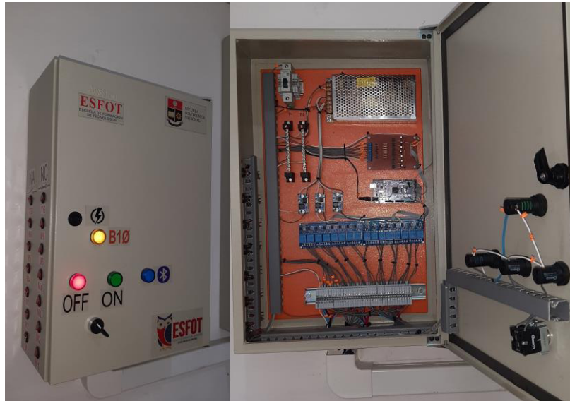
Figura 3.69 Tablero de control 3 en LTI (TDC3LBLTI).
