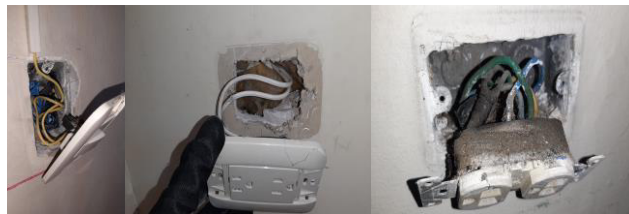
Figura 3.32 Interruptor simple y tomas 12 y 17 del laboratorio de Eléctrica y Electrónica.
