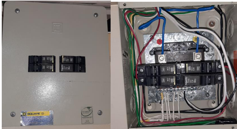
Figura 3.79 Tablero de distribución secundario 1 en el Laboratorio de TICS 22 A (TDS1LB22A).
