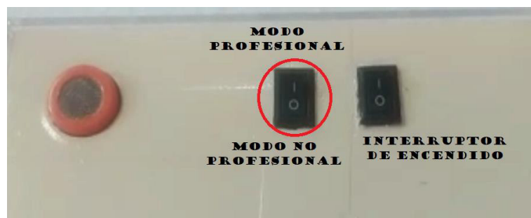
Figura 3.38 Disposición de interruptores en el case
