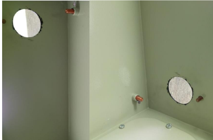
Figura 2.13 Perforaciones en la parte superior y lateral derecha del gabinete.
