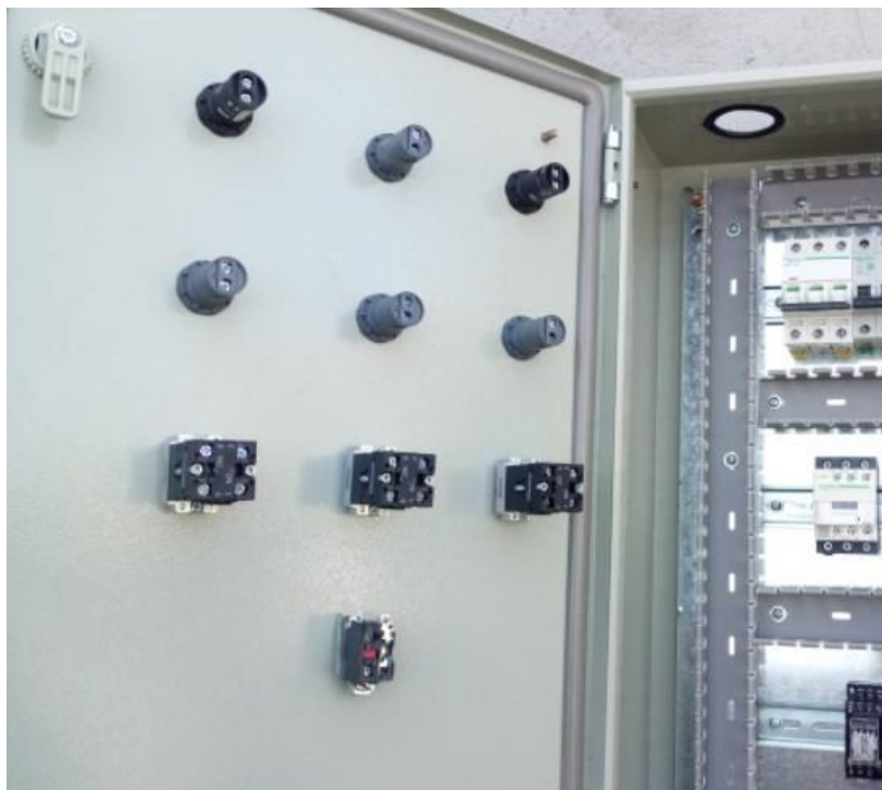
Figura 2.15 Distribución de elementos de mando y luces piloto en el interior.
