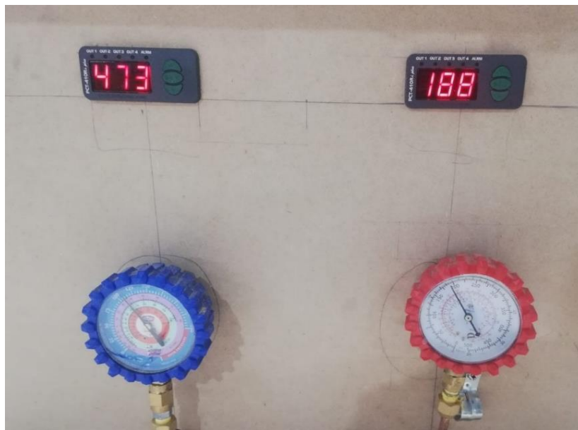
Figura 2.22 Presión de presurización en la línea de alta y baja (13 de julio)
