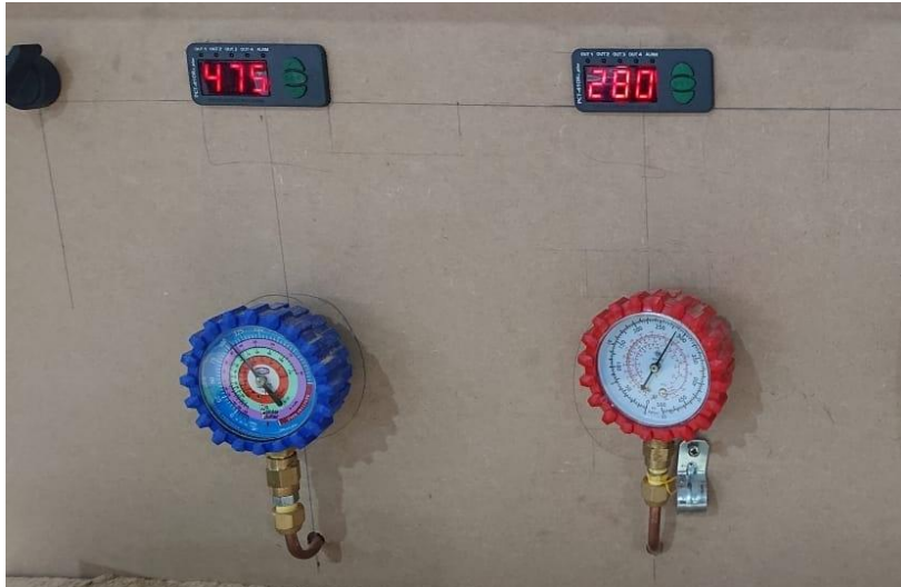
Figura 2.21 Presión de presurización en la línea de alta y baja (12 de julio)
