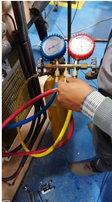
Figura 2.16 Tanque de nitrógeno con juego de manómetros
