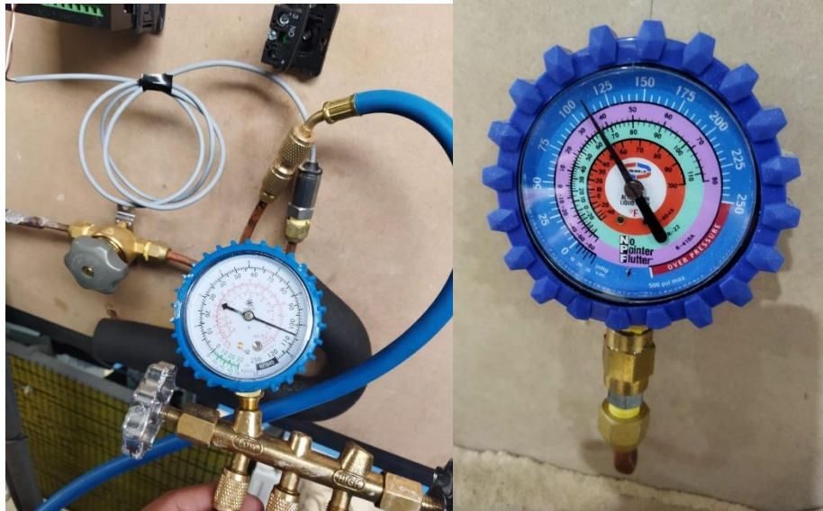
Figura 2.19 Presurización en el manómetro de baja
