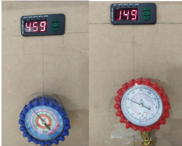
Figura 2.25 Presión de presurización en la línea de alta y baja (18 de julio)
