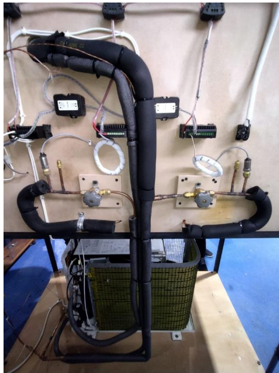
Figura 3.4 Sistema de refrigeración
