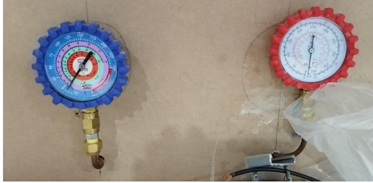
Figura 2.27 Presión en los manómetros
